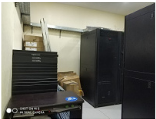
【写真6】MPWTのサーバ室。車両登録システムと車検システムが稼働しており、港湾EDIシステムも隣接して設置する予定。
