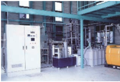
破壊処理プラント
