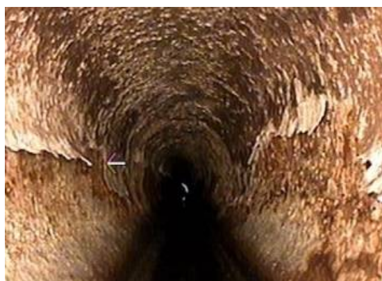
コンクリート・ヒューム管の腐食例
