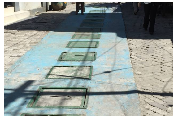
パイロット地区の集合浄化槽のマンホール (スラバヤ)
