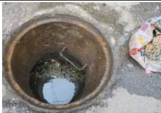
実証テスト候補地の視察① マンホール内の滞水（未処理水）
