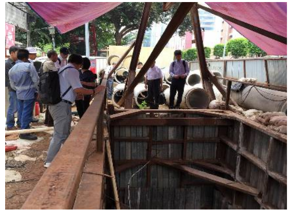
Zone-0 内の小口径推進工事現場 (立坑の側壁の強度不足で、工事中断中)
