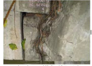
ゲルバーヒンジ構造の採用による 継手部の早期損傷(フィリピン)
