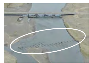
支間割や河道の変位等に対する適切な計 画が行われず、橋梁が流出した事例(モン ゴル)
