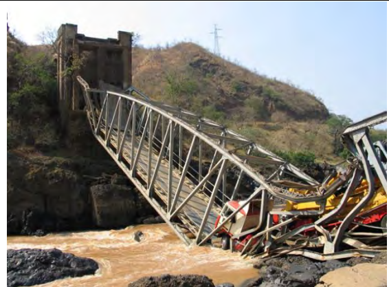
図 2-32 車高が規制を超え、上部工が損傷した事例（エチオピア）
