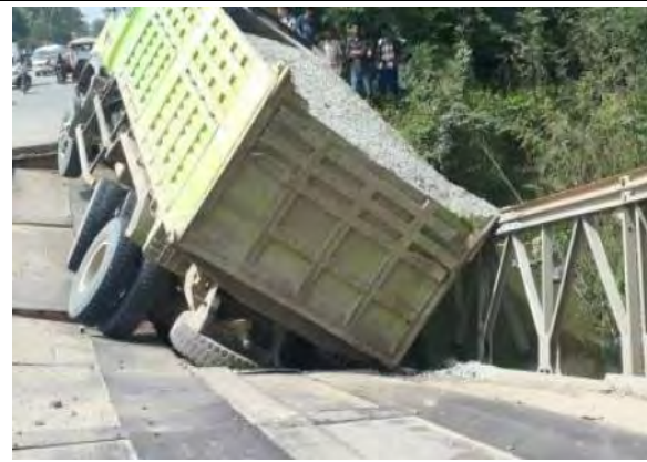
図 2-31 典型的な過積載による橋梁損傷（カンボジア）
