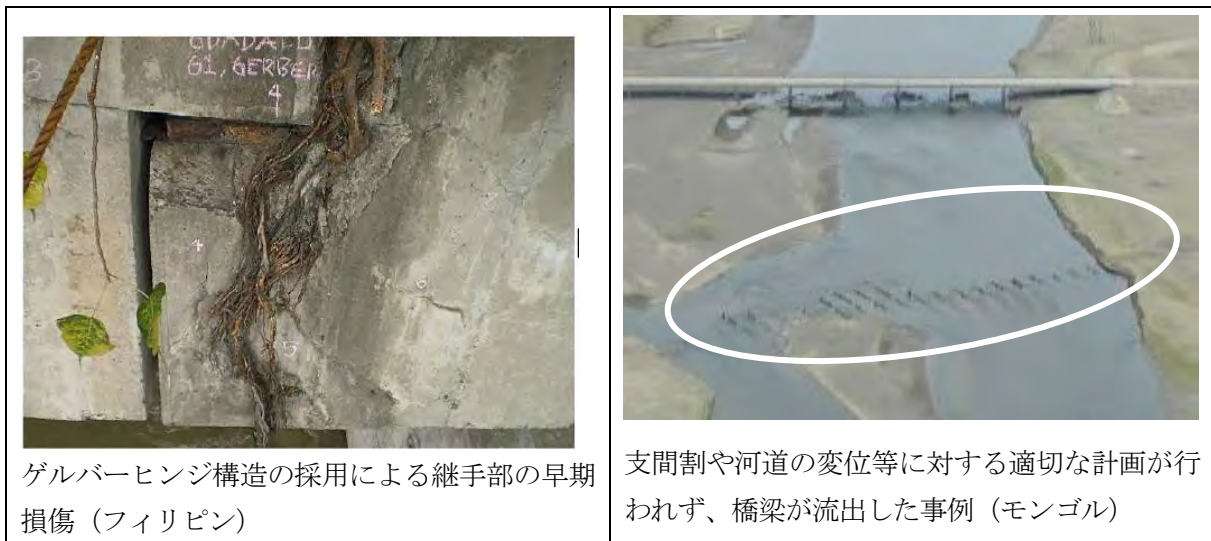
図 2-5 橋梁計画が不適切で機能が低下または損傷している事例
