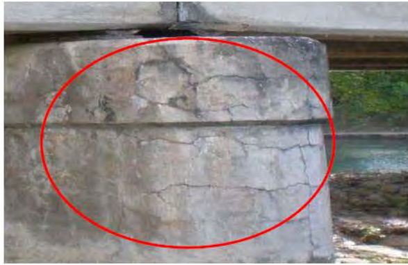
塩害によるコンクリートのひび割れ（フィリピン）
