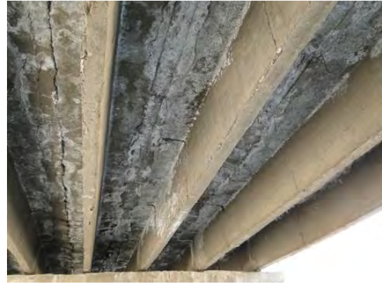
床版の防水工が十分に施工されておらず、建設直後から遊離石灰が発生する。（モンゴル）
