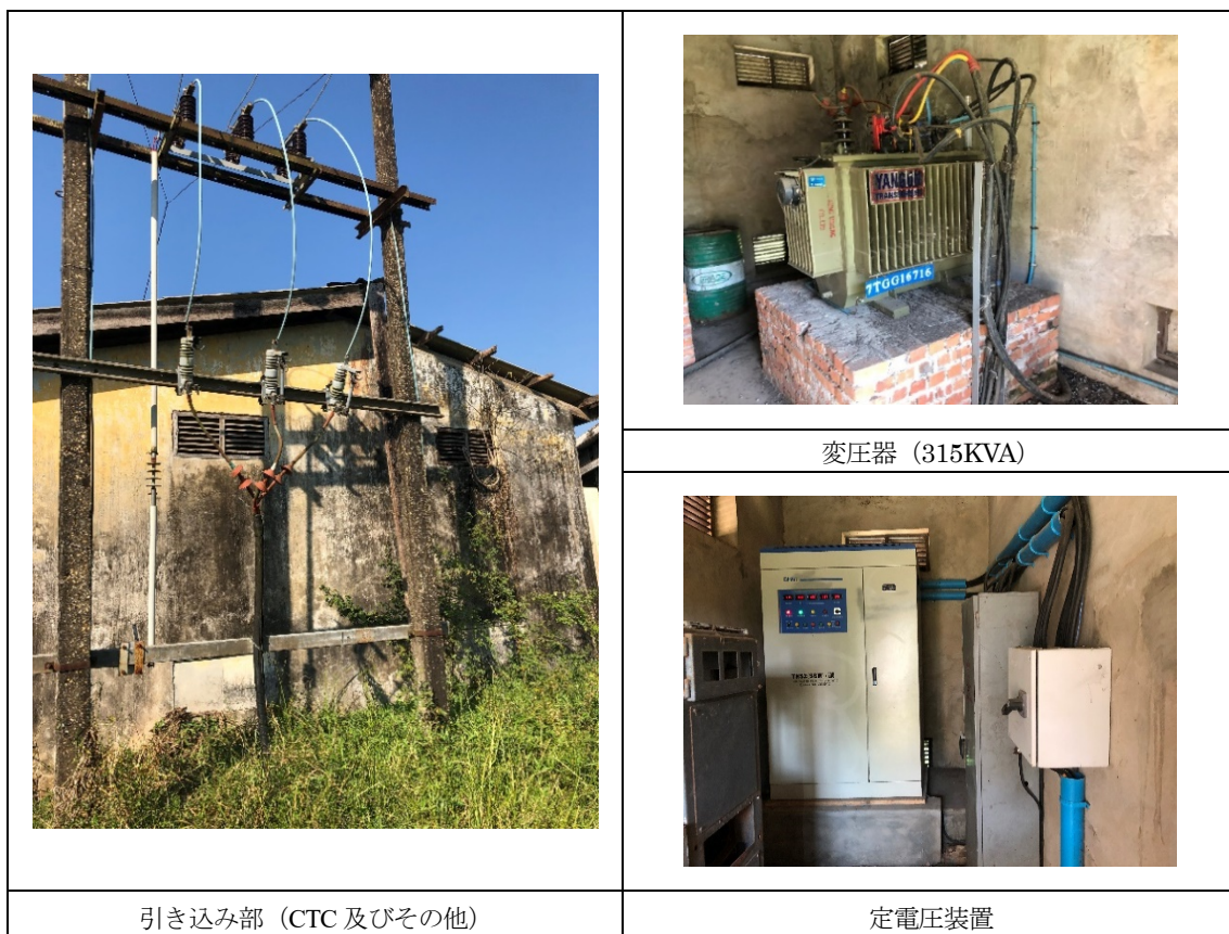
図 2-37 CTC 他用受変電設備の現況
