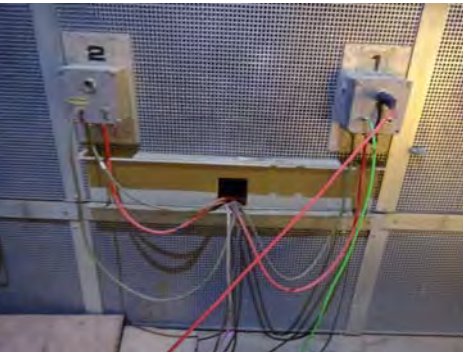
写真-5：第1スタジオ側配線パネル
