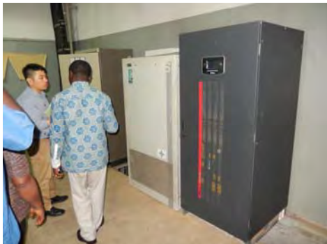
写真-15：スタジオ・主調整室用 UPS
