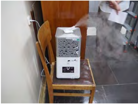
写真-9：古書・貴重書保管室に設置された加湿器。エアコンも整備されている
