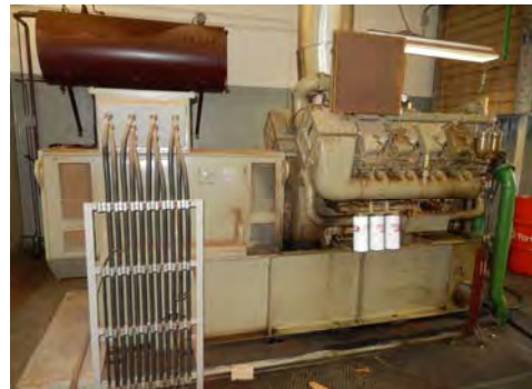
写真-16：CRTV 全体用バックアップジェネレータ
