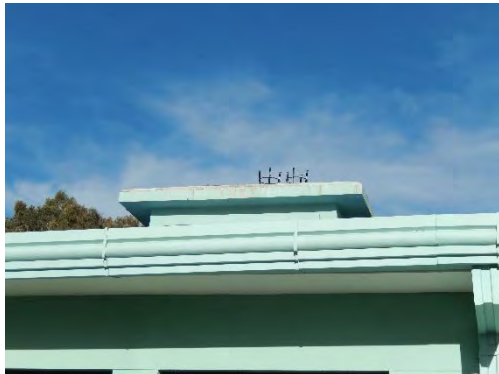
写真-11:アンテナ設置スペース
