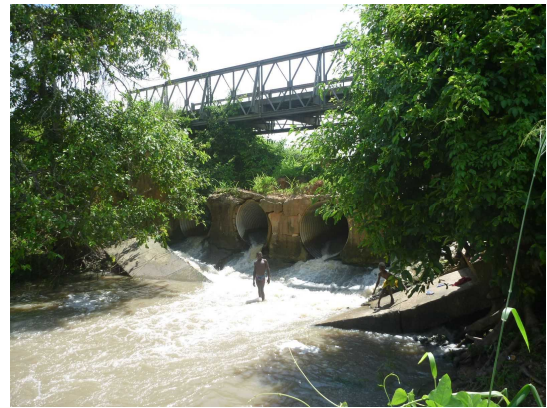
写真-10 ムンゴエ橋 パイプカルバートが沈下、崩壊し、ベイリー橋により供用している様子を示す。
