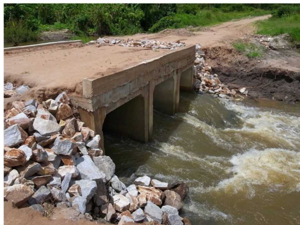
迂回路のボックスカルバート(侵食により現在通行不可)
