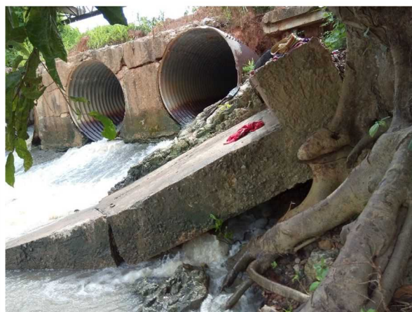
既設カルバート及び既設構造物の損傷
