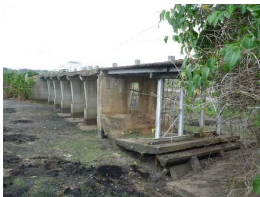
写真-5 ムエラ I 橋 橋台からの2径間は橋脚が倒壊し、その上に仮設支柱を設置し、仮設桁により交通を供用している。
