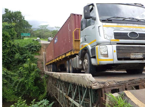
落橋直後の様子（2019年1月）
