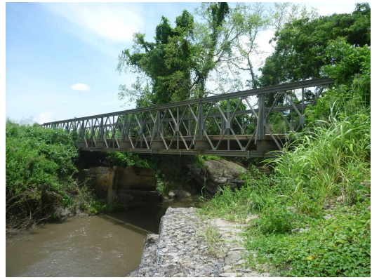
写真-2 ムアガムラ橋 橋梁側面を示し、ベイリー橋下部に落橋した橋台が残存している様子を示す。
