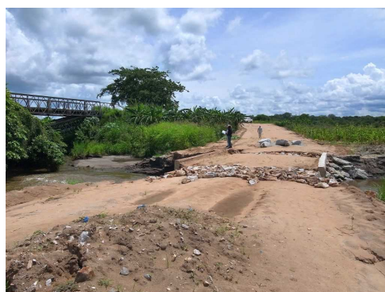
上流側の迂回路（現在通行止め）
