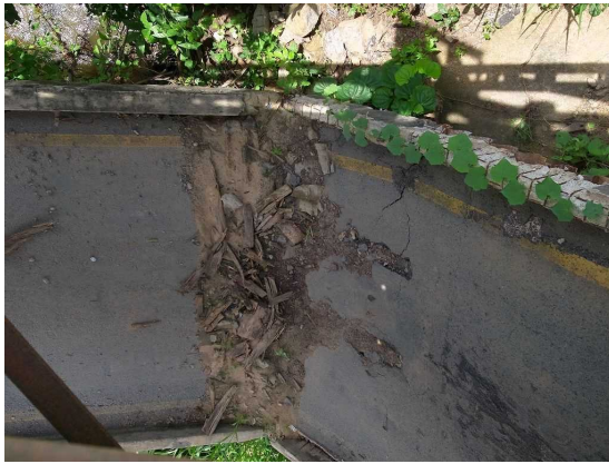
落橋し折れ曲がった床版
