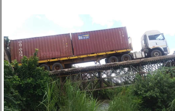
写真-8 ムエラ II 橋 2019 年、大型トレーラー通過時に落橋した際の状態を示す。
