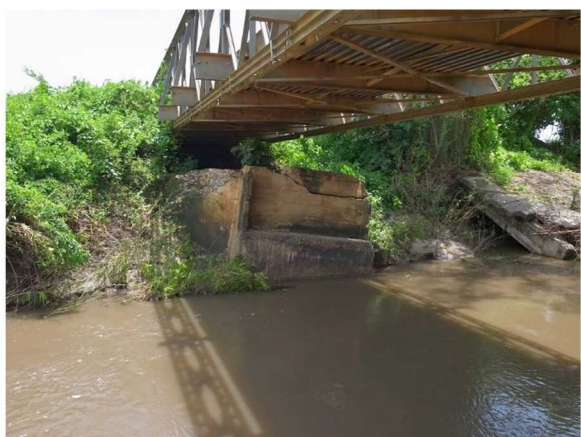
既設橋梁の損傷
