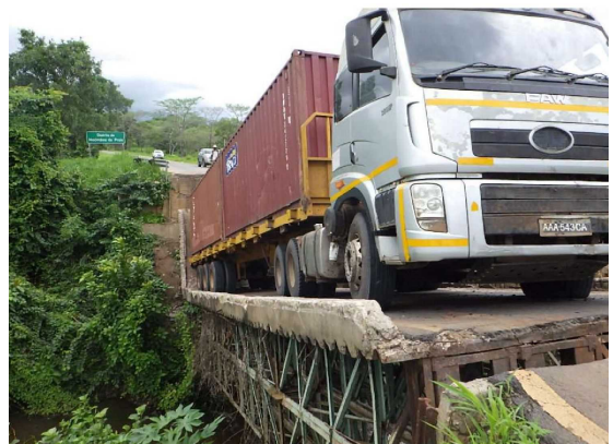
落橋直後の様子（2019年1月）
