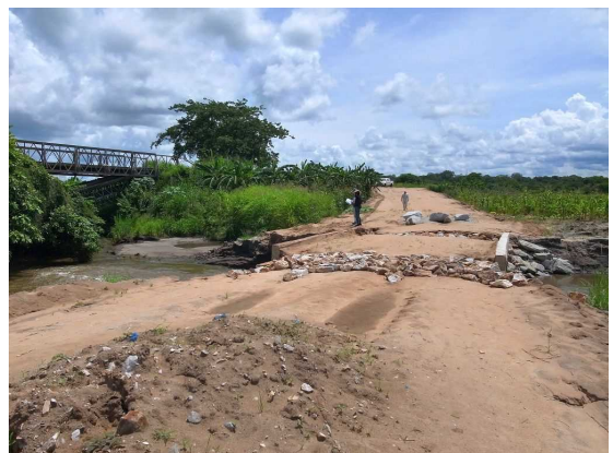
上流側の迂回路（現在通行止め）
