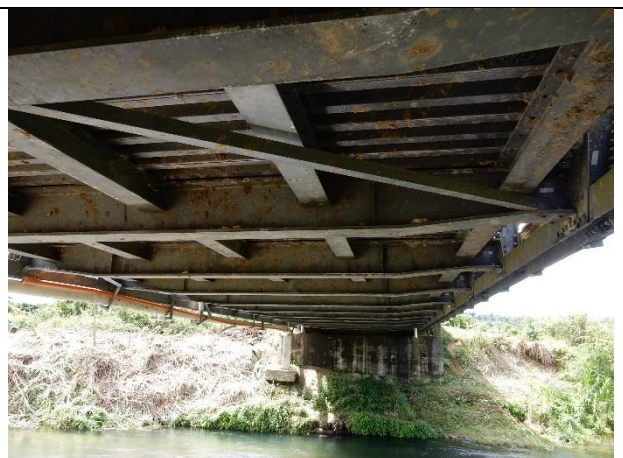
テオウマ橋の上部工の状況／氾濫により土が付着している。
