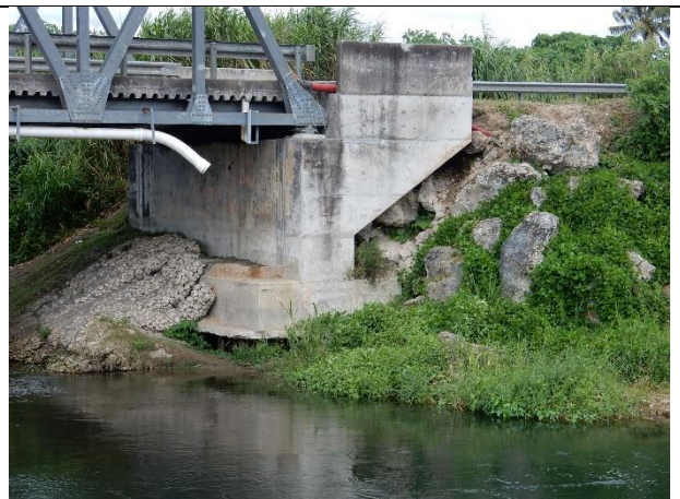
テオウマ橋右岸の橋台取付部の損傷部に対する応急措置、橋台保護の蛇籠は流失
