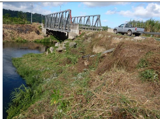
テオウマ橋上流部の右岸の洗掘状況／ガードレール損傷
