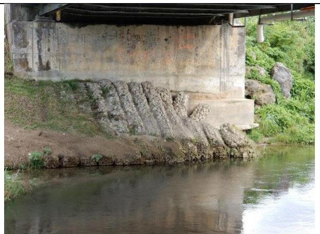
テオウマ橋右岸護岸の蛇籠流出の状況
