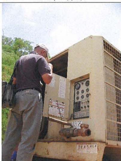
コンプレッサーの確認(Andranohinaly) 2014年12月8日
