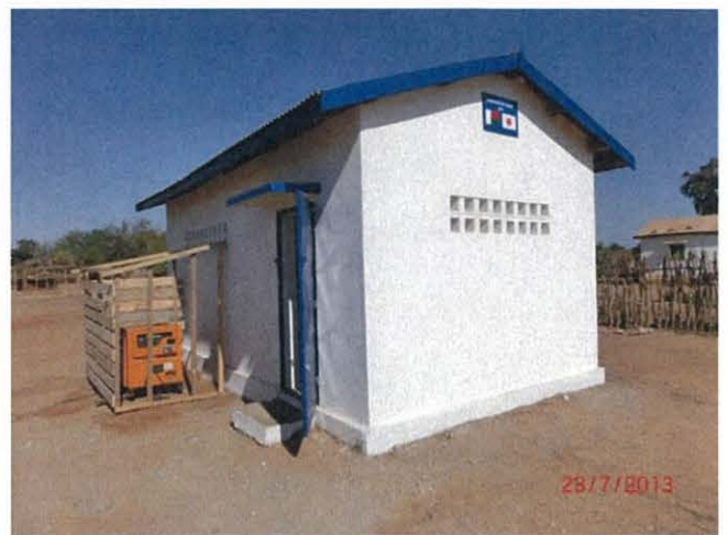
改修後／発電機室（2013年7月23日）
