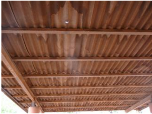
屋根材の劣化状況
