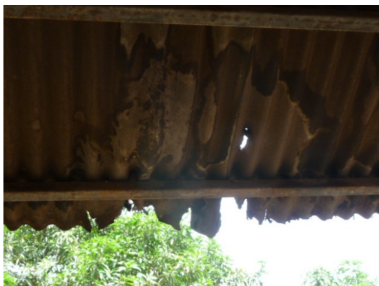
屋根材の劣化状況
