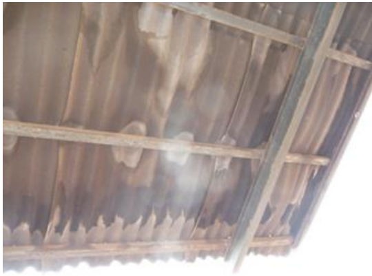
屋根材の劣化状況
