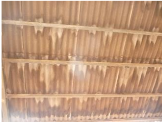
屋根材の劣化状況
