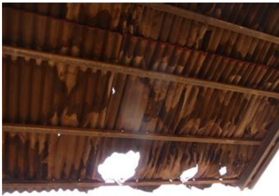
屋根材の劣化状況
