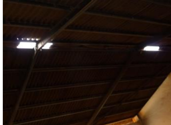
教室内部 屋根 棟に大穴
