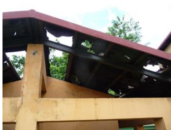
トイレの屋根 劣化が激しい
