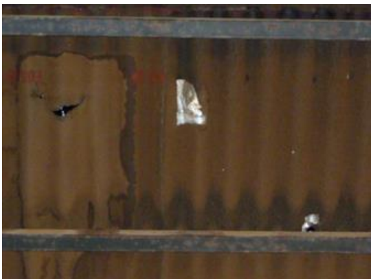
教室内部 屋根（テープでの補修）
