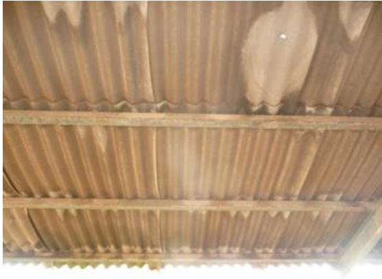
屋根材の劣化状況
