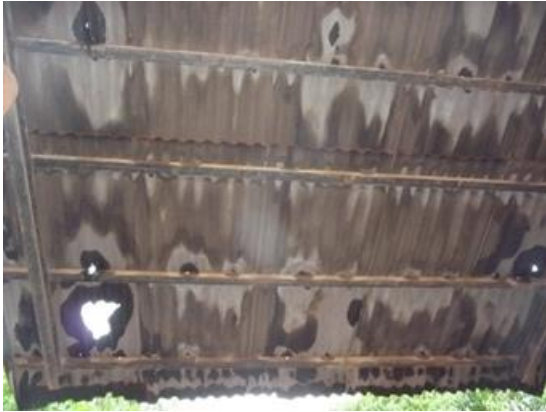
屋根材の劣化状況
