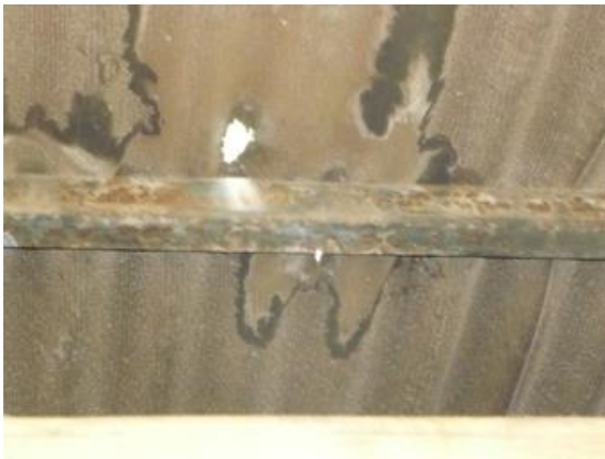
屋根材の劣化状況
