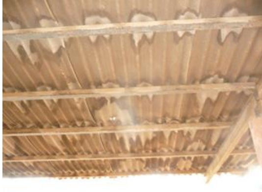
屋根材の劣化状況
