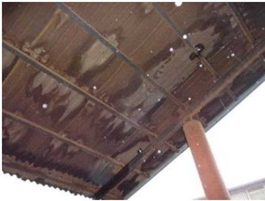
屋根材の劣化状況
