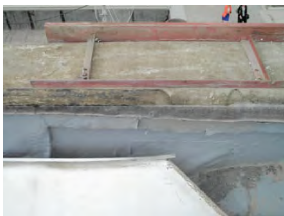
写真⑭：笠木内部の劣化した支持材と防水シート
