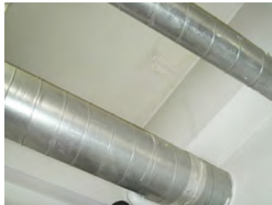
写真⑧：1階倉庫の天井漏水痕跡状況
