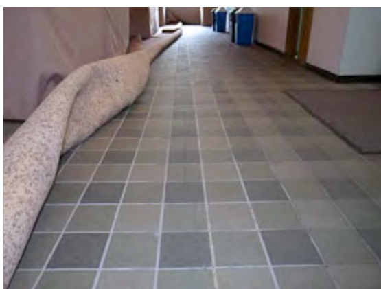
写真㉔：1階ロビーへの廊下床タイルの亀裂状況
