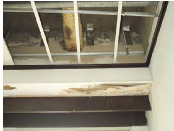
写真⑥：2階会議室の内壁・天井漏水状況
