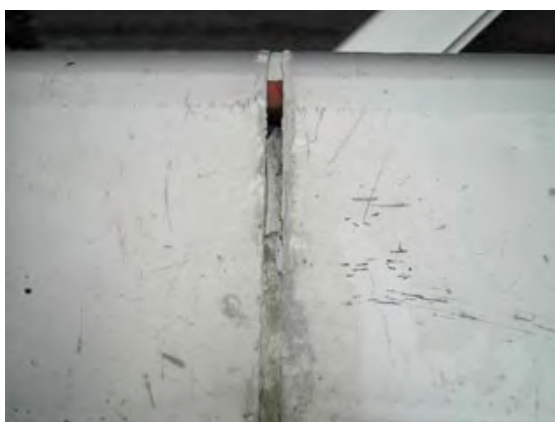
写真⑬：笠木ジョイント部コーキング不良状況
