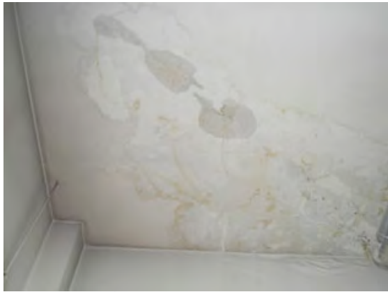
写真⑤：2階倉庫の天井漏水状況
