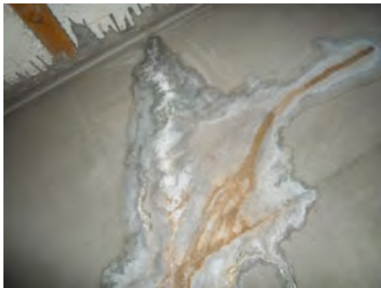
写真⑦：1階図書室の天井漏水痕跡状況
