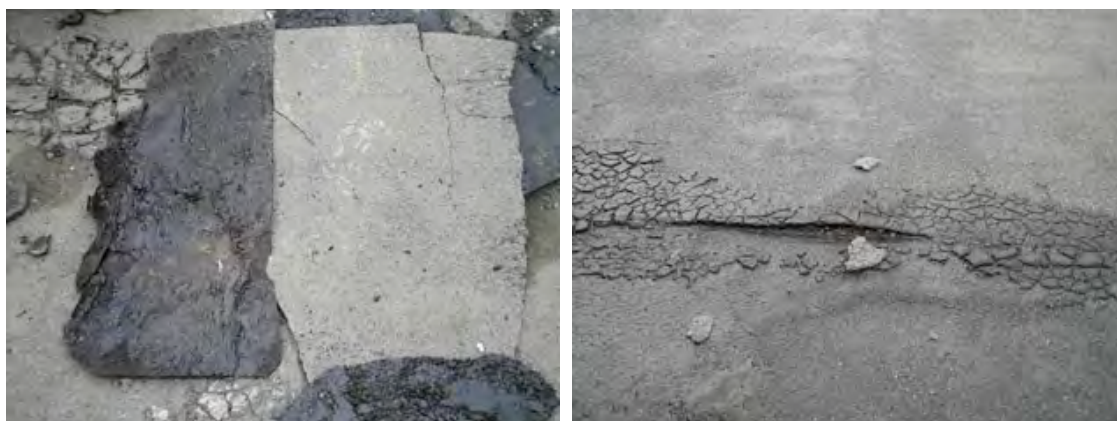
写真⑨：採取したアスファルトシート劣化状況 写真⑩：シートジョイント部分の隙間
