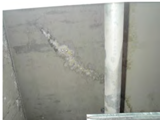
写真②：2階講師室の天井漏水状況
