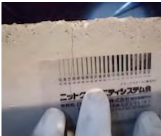
写真③③：2階廊下大梁部分クラック状況
