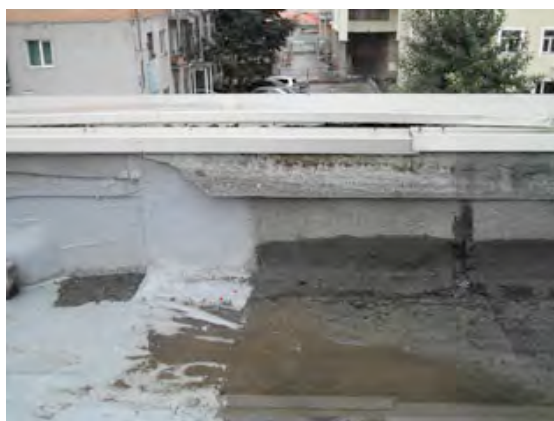
写真⑫：笠木と立ち上り部分の施工不良状況
