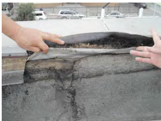
写真⑪：笠木下部のシート未接着状況
