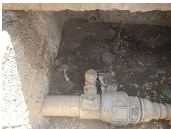
写真 4 : 仕切弁の故障のため使用されていない公共水栓の弁室内 (ケレワン)
