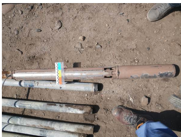
写真 6 : 揚水量が減少したとのことから使用されなくなった試掘井の水中ポンプ (ネメレフェン)
