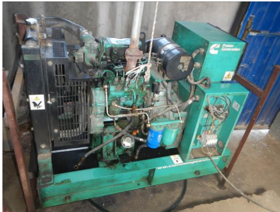
写真 7：2014 年に AWRB により交換された発電機（ネメレフェン）
