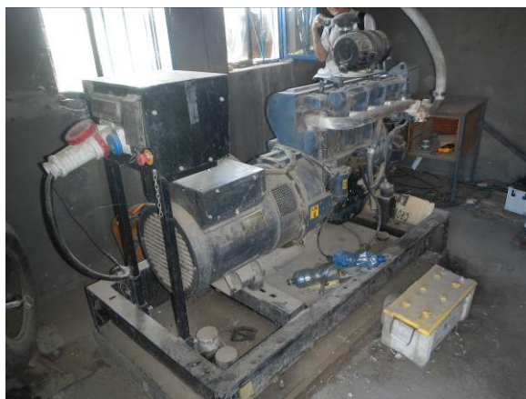
写真 2 : 2015 年に AWRB により交換された発電機 (グビドゥラ)
