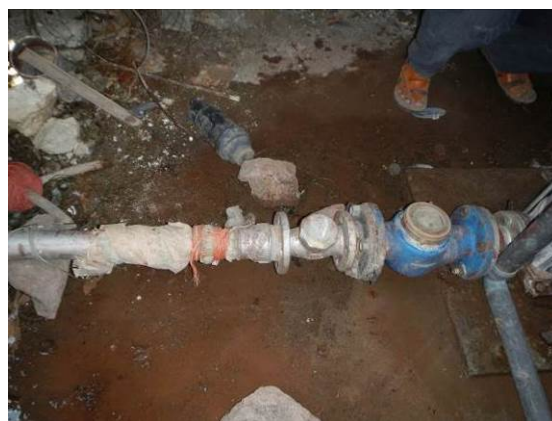
図 2-46 ポンプ周りの配管
