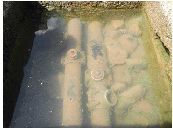
図 2-30 送水管および弁室
