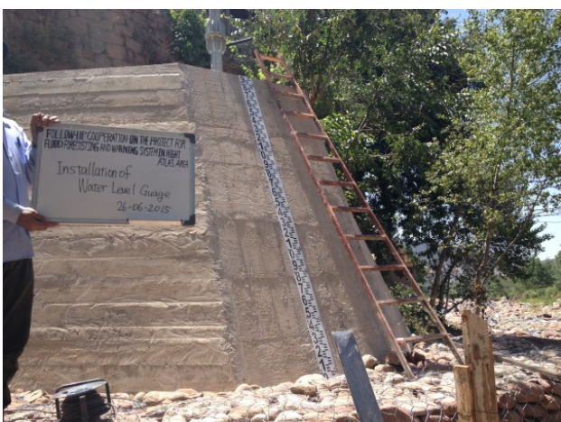
26 juin Installation de la jauge du niveau d'eau sur la structure en béton
