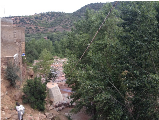
10 juillet Installation du câble et du fil (entre le bras et le poteau de 3m)
