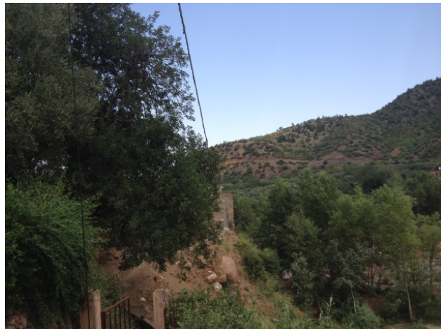
10 juillet Installation du câble et du fil (entre poteau de 3m et le poteau de 5m)
