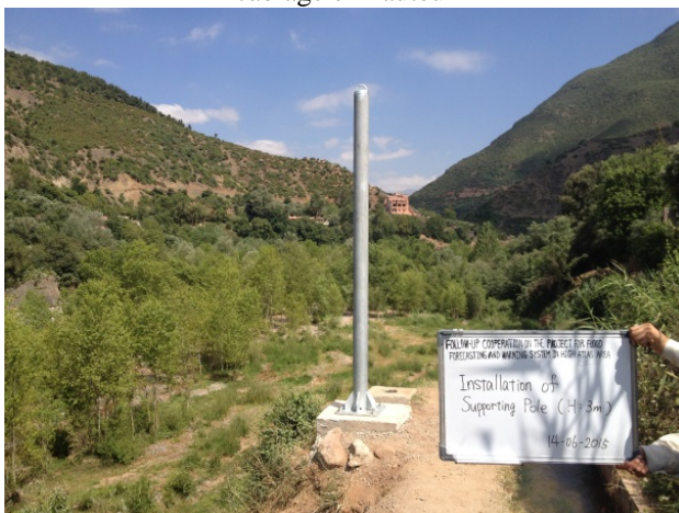
14 juin Installation du poteau en acier (3m) pour le câblage en hauteur
