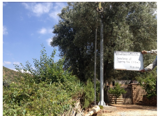
14 juin Installation du poteau en acier (5m) pour le câblage en hauteur
