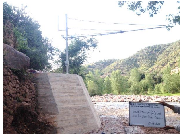
15 juin Installation du bras du poteau pour la jauge du niveau d'eau
