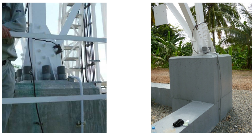
(1) ヒュー・チール 引下げ導線
