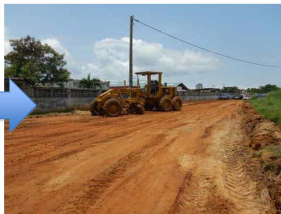
La route a pu être refaite grâce à des dons d'hommes politiques (mars 2019). Des travaux de revêtement sont toutefois indispensables.
