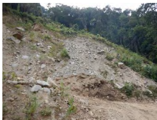
Photo 6 A-5 発電所地点周辺の斜面崩壊
