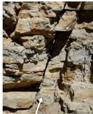
Photo 4 開口割れ目 (左岸)
