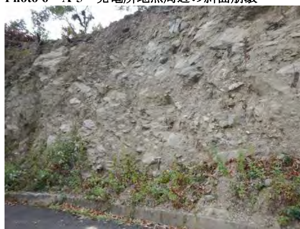
Photo 7 A-5 発電所周辺の未固結堆積物
