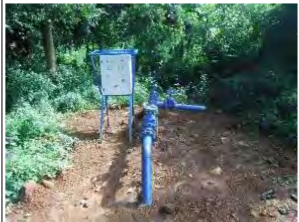
深井戸地上設備完成写真
