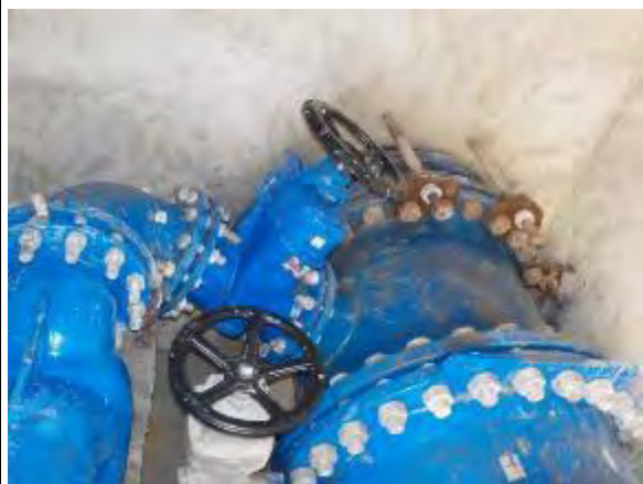
16. ENTA 地区の減圧弁内部状況、口径 900 mm x 口径 250 mm下流から上流を望む。
