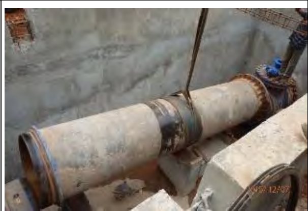
20. 自動緊急停止バルブ 弁室工事中に設置した仮管の撤去 撮影：2015年12月7日
