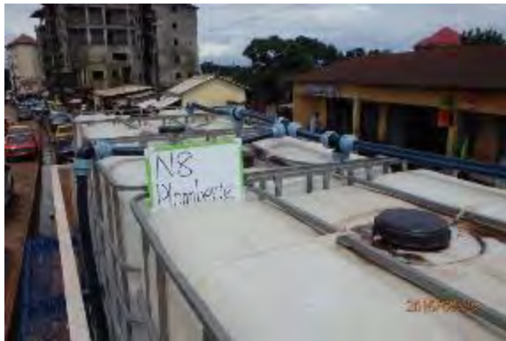
9. No8 Face Parc camion 水槽上の配管 撮影：2016年4月27日
