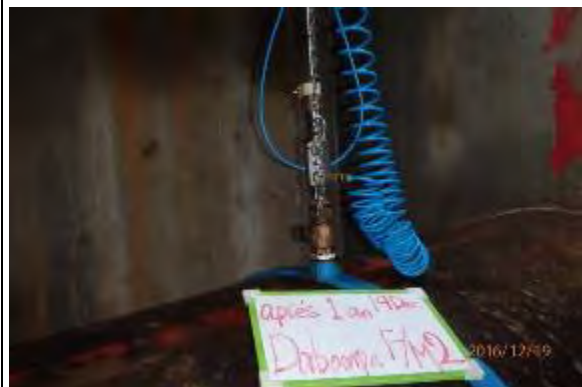
22. Dabompa 地区 F/M-2 流量計設置状況。(稼働中)
