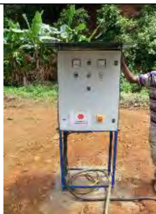
2. FK2 水中モーターポンプ制御盤 撮影：2017年8月30日
