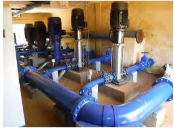
写真-8: コバヤポンプ場送水ポンプ
