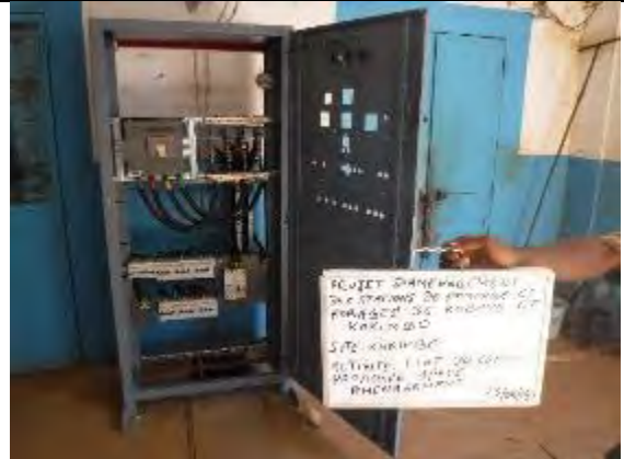
12. カキンボ送水ポンプ場電気室内配線工事 仮設電源盤の状況（内部） 撮影：2016年8月22日
