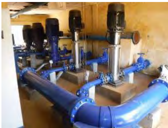
送水ポンプ及びバルブ等完成写真
