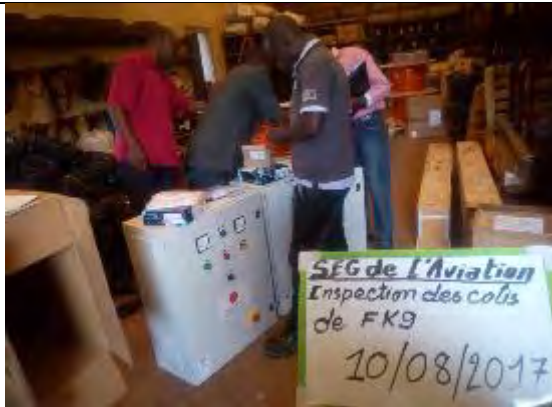
7. クラウンエイジェンツ調達水中モーターポンプ制御盤検収 撮影：2017年8月10日
