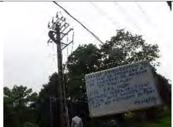
28. カキンボ EDG による電柱への高圧電気ケーブル接続作業 撮影：2018年8月19日
