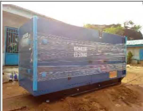
550kVA ディーゼル発電機
