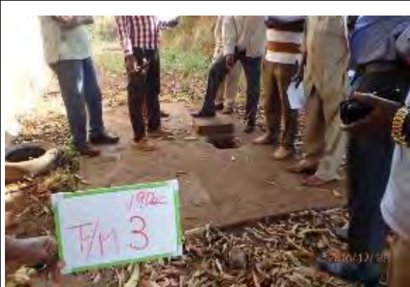
23. Sangoya 地区、JICA2 配水池用地内口径 300 mm 流入管に流量計設置既設弁室状況、下流から上流を望む。
