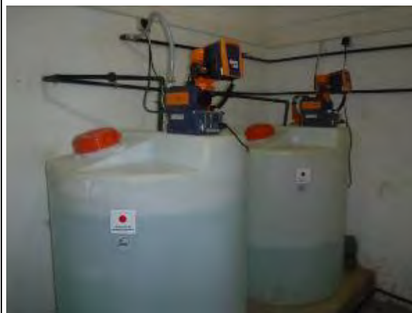
薬品注入装置完成写真
