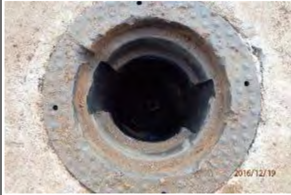
18. Sangoya 地区の JICA2 配水池取り出し口径 250 mm 制水弁渠状況、(弁柵上部)
