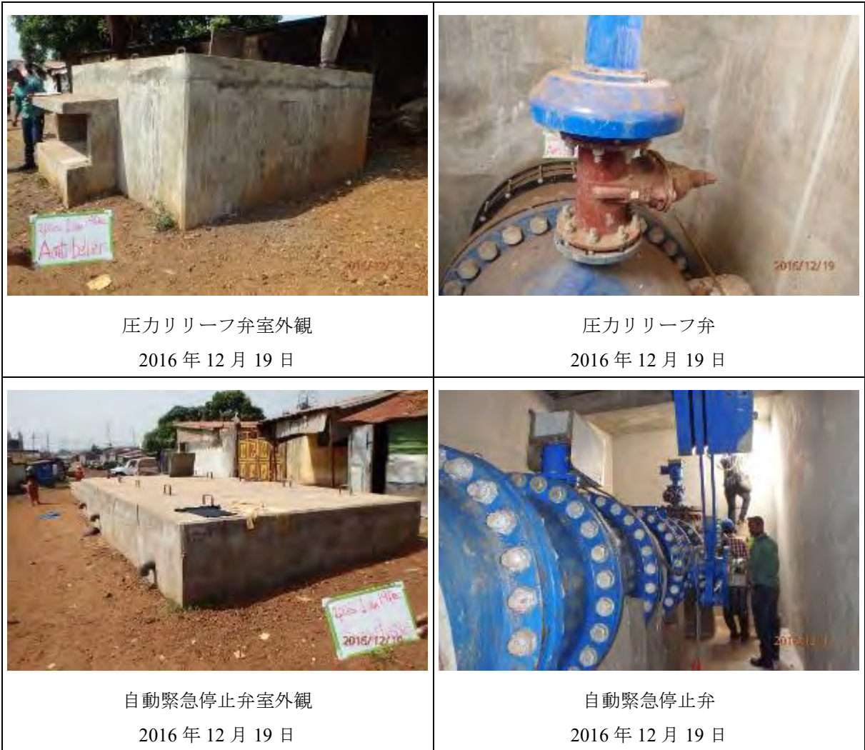
図 4-5 自動緊急停止弁関連 施設・機材状況
