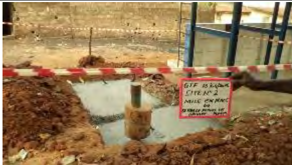
3. No.2 Près de chez Fofana Syndicat 井戸ピットの レベルコンクリートの打設 撮影：2016年4月18日
