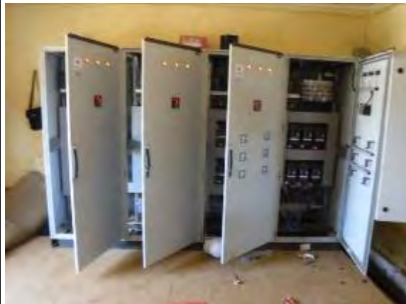
低圧盤完成写真
