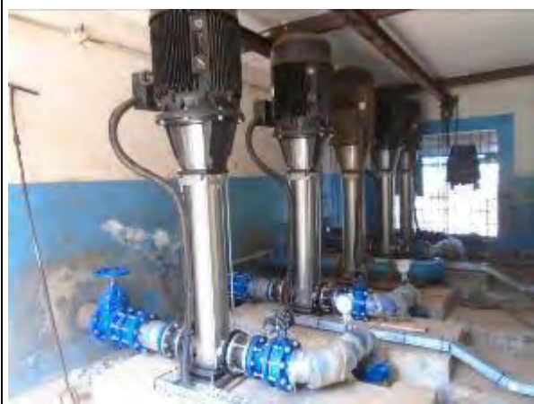
送水ポンプ及びバルブ等完成写真
