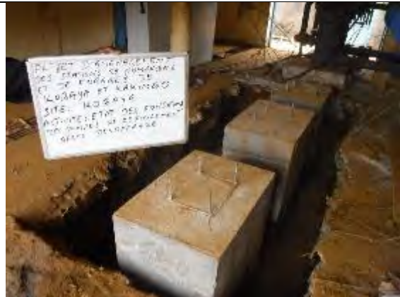
6. コバヤ送水ポンプ設置工事 基礎鉄筋コンクリート打設完了 撮影：2018年2月14日
