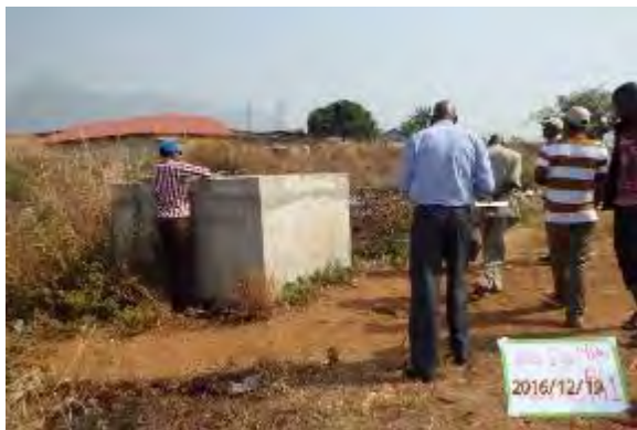
19. Nestlé 地区、流量調整弁下流の流量計弁室外部状況、口径 700 mm 下流から上流を望む。
