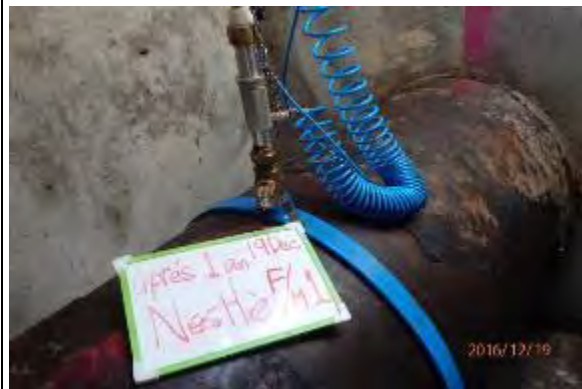
20. Nestlé 地区、F/M-1 弁室内口径 700 mm 流量計設置状況。(稼働中)
