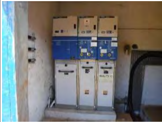
高圧盤完成写真
