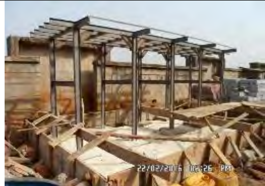
6. No.24 Face chez Koro Dabo (SEG) 水栓底盤型枠工事 撮影：2016年2月22日
