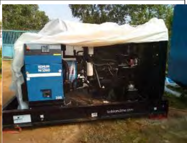
250kVA ディーゼル発電機
