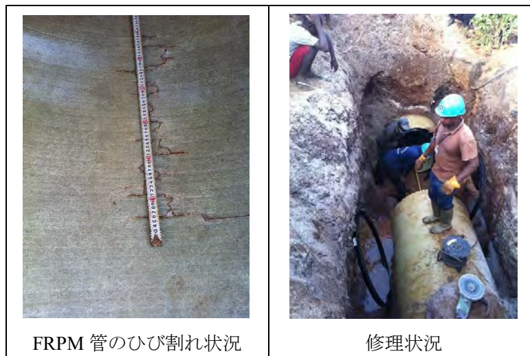
図 1 漏水と修理（2015 年 3 月 7 日）
