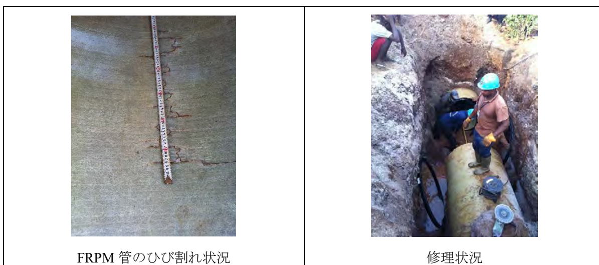
図 4-11 漏水と修理 (2015 年 3 月 7 日)
