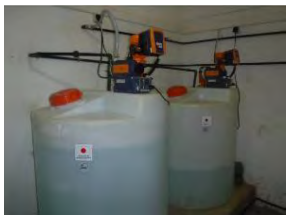
写真-12: カキンボ薬品注入装置
