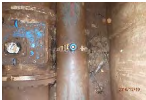
24. Sangoya 地区、JICA2 配水池への流入管口径 300 mm に流量計 F/M-3 設置状況。流量計本体は修理のため仏国メーカーにて補修中。
