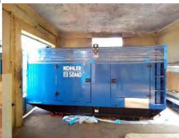
250kVA ディーゼル発電機
