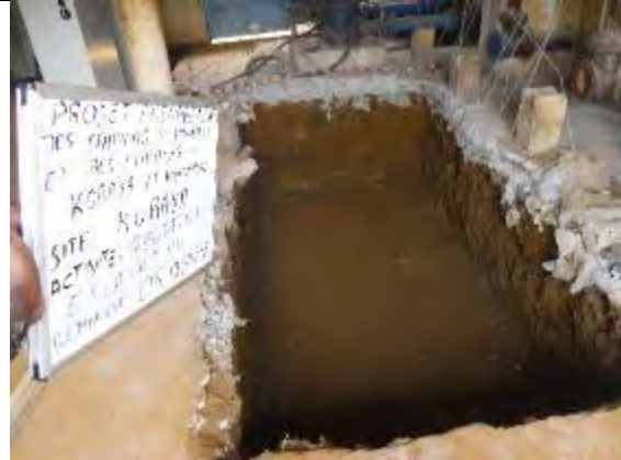
2. コバヤ送水ポンプ設置工事 基礎掘削工事完了 撮影：2018年1月13日
