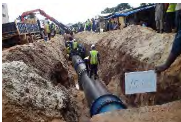
12. 自動緊急停止バルブ FRPM 管からダクタイル鉄管への交換工事 管設置状況 撮影：2015年9月10日
