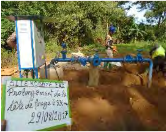
写真-7: コバヤ FK9 深井戸地上配管
