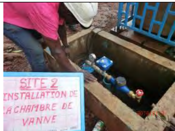
10. No2 Près de chez Fofana Syndicat 井戸ピット内の配管 撮影：2016年8月13日
