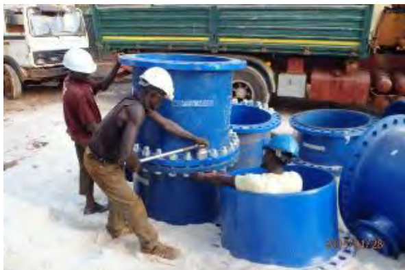
17. 自動緊急停止バルブ 管の事前接続 撮影：2015年10月6日
