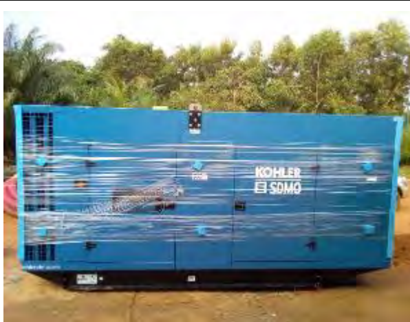
550kVA ディーゼル発電機
