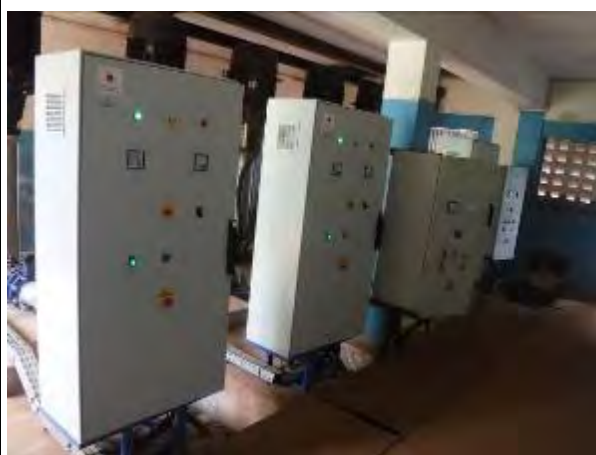
送水ポンプ制御盤完成写真
