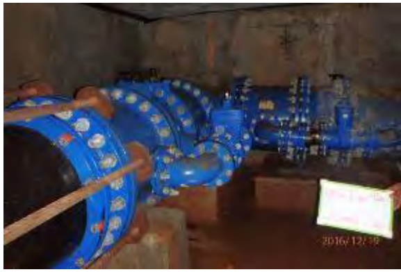
11. Dabompa 地区のバイパス弁室内部状況、口径 1100 mmから口径 700 mm接続状況。
