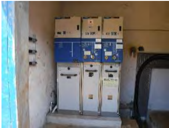
写真-9: カキンボポンプ場 高圧盤
