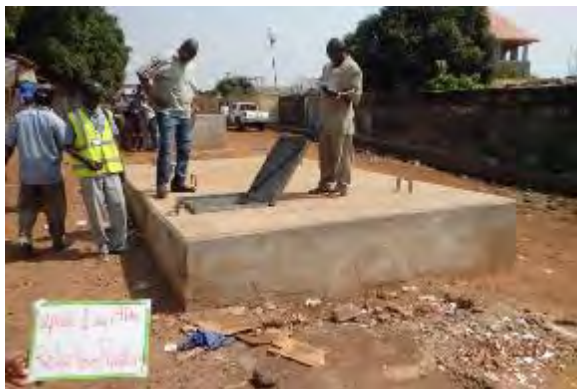
13. ENTA 地区の減圧弁外部状況、下流から上流を望む。
