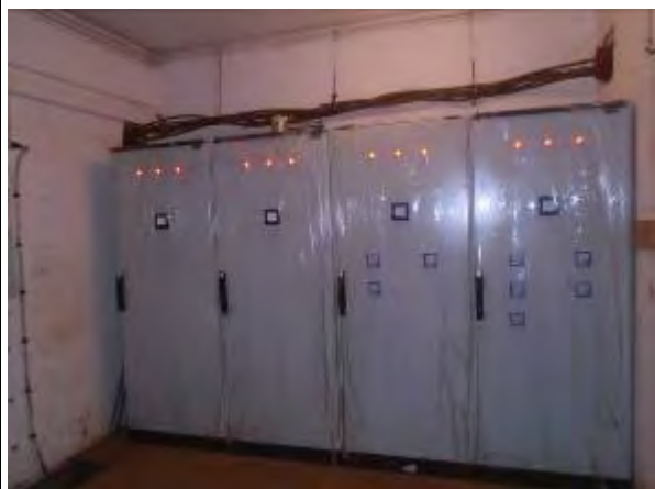
低圧盤完成写真
