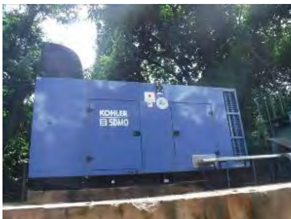
写真-11: カキンボ 550kVA ディーゼル発電機
