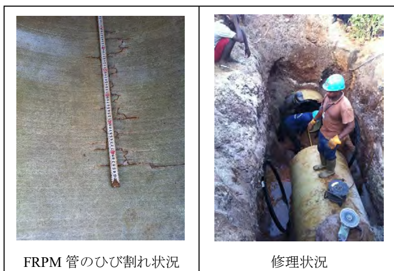
図 5-1 漏水と修理（2015年3月7日）
