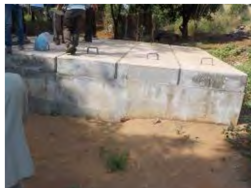
10. Dabompa 地区のバイパス弁室外状況、既設口径 700 mmの下流を望む。 撮影：2016年12月19日
