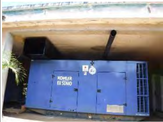
550kVA ディーゼル発電機据付完成写真
