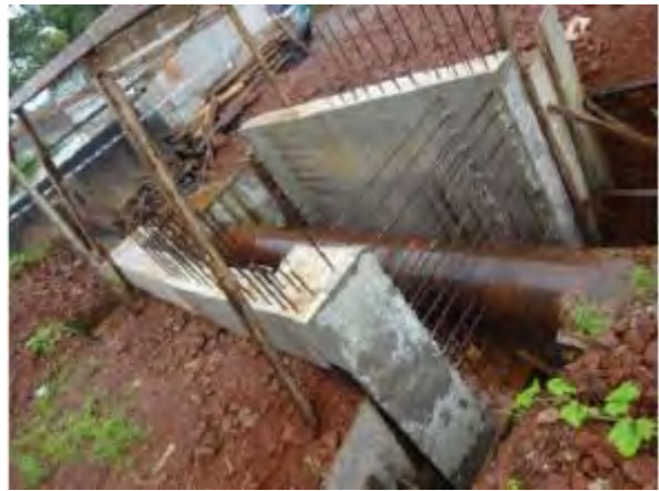
16. Nestlé 地区、鋼管口径 700mm 流量調整弁室 状況。 撮影：2015年10月1日
