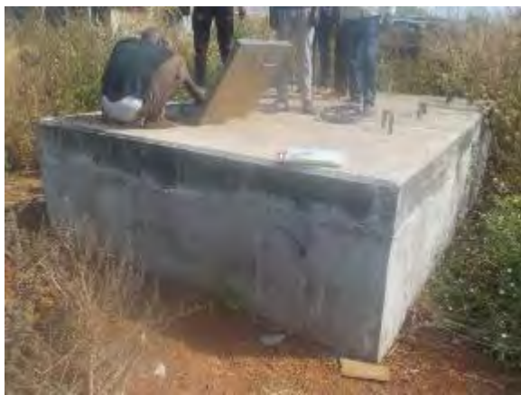
5. Nestlé 地区の流量調整弁室状況、上流を望む。 撮影：2016年12月19日
