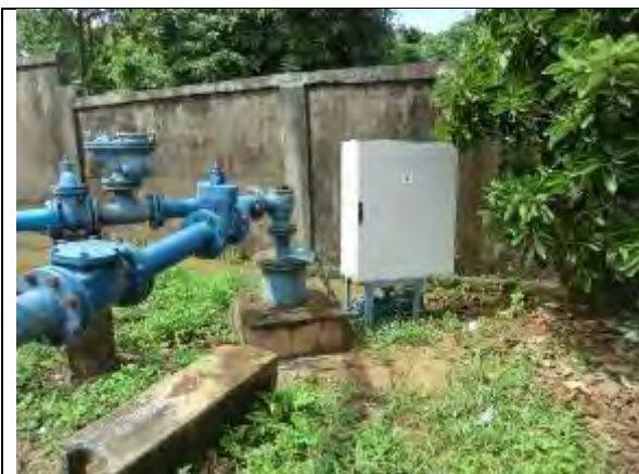
1. FK4 水中モーターポンプ制御盤 撮影：2017年8月26日
