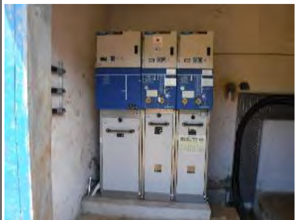
高圧盤完成写真
