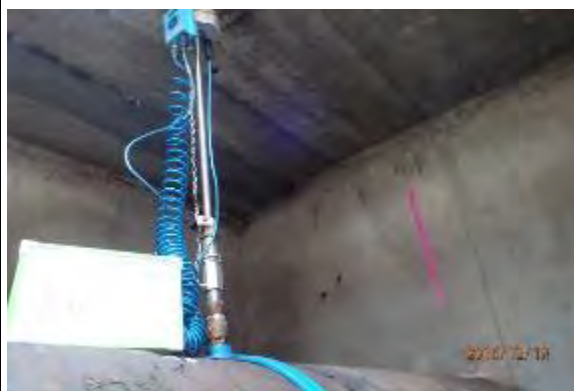
26. Sangoya 地区、F/M-4 流量計設置状況。 (稼働中)
