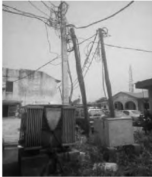
Existing Transformer 1*300KVA、11/0.415KV
