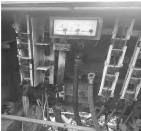
既存フィーダーピラー
