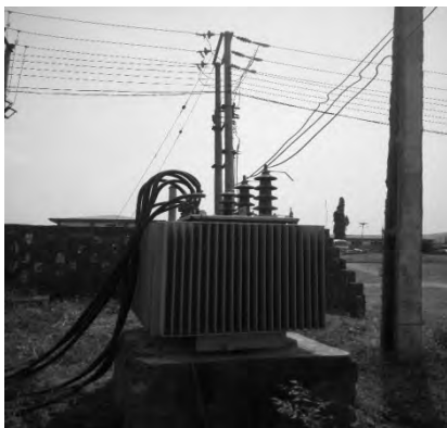
既存変圧器 2*500KVA, 33/0.415KV
