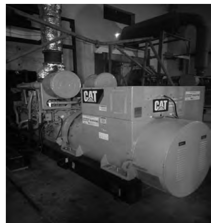
既存発電機のうちの 1 台、合計 6MW
