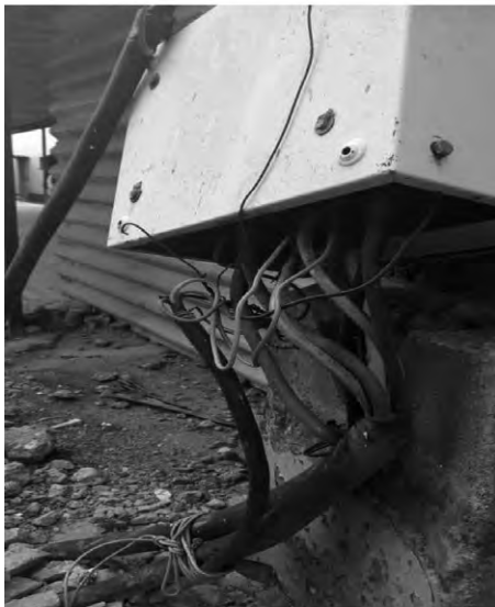
既存コネクタースイッチ 7.5MVA 33/11kv
