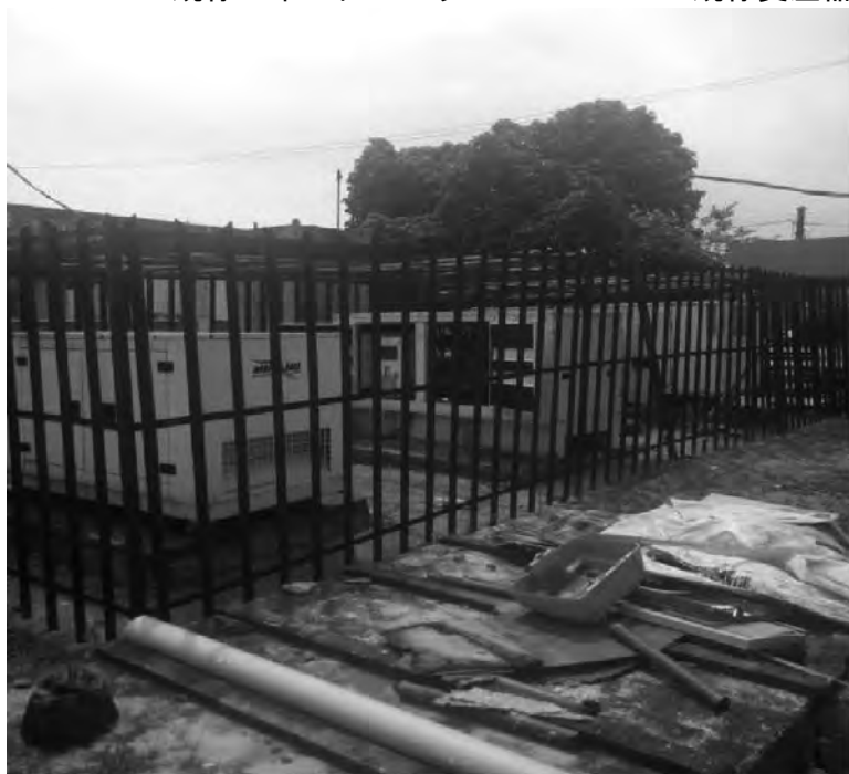
既存発電機 3 台、 2 台 (1*27KVA, 415V、1*20KVA, 415V) 使用可能
