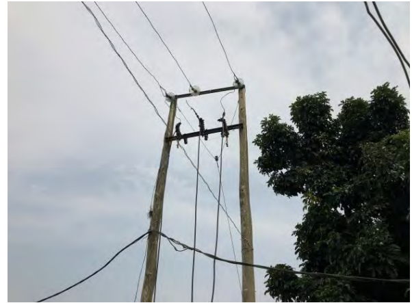
11kV 中圧配電網の引き込み電柱
