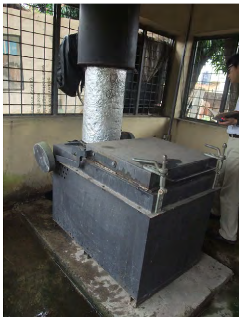
写真7 CPHL 焼却炉。行政による焼却灰、医療廃棄物の回収は行われておらず。構内で埋設処理している。
