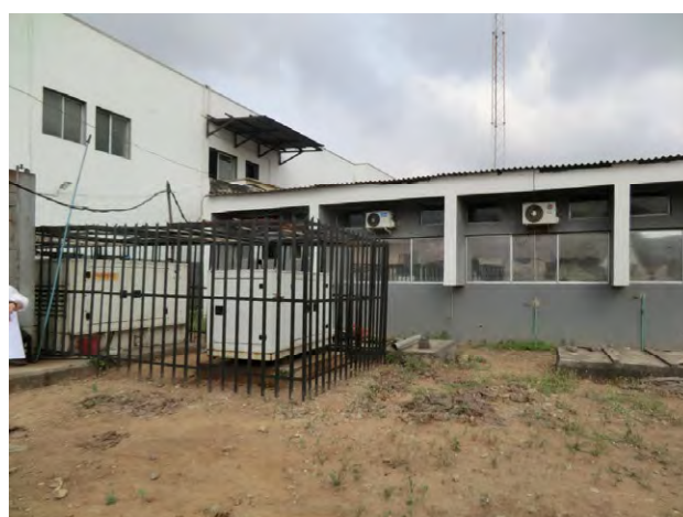
写真6 CPHL 非常用発電機および浄化槽群。NRL 同様に2層式で場内浸透処理を行っている。
