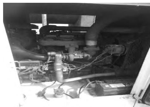
既存発電機のうちの1台
