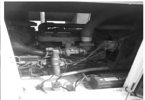
既存発電機のうちの 1 台
