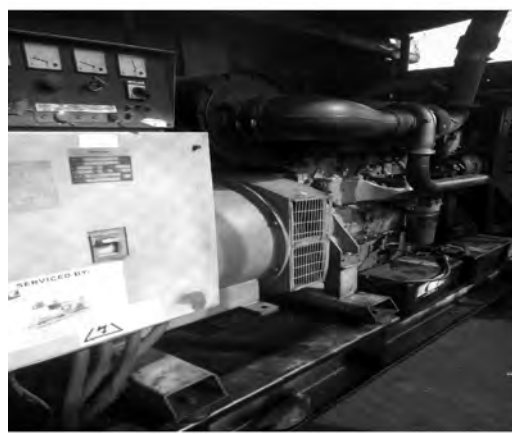
既存発電機のうちの1台 1*500KVA
