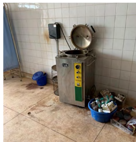
UNTH 洗浄室。部屋の大きさは十分あるが機材は老朽化している。
