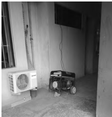
検査室専用既存発電機 1*2.5KVA, 220/240V
