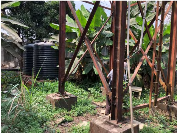
既存施設へは、井戸水をポンプアップして上水の引き込みを行っている。写真奥、地上置き型の樹脂製受水槽。容量は5トン×2基。
