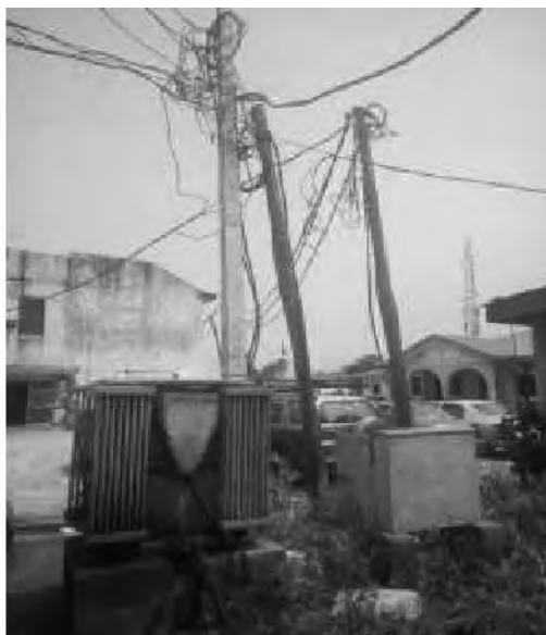
既存変圧器 1*300KVA、11／0.415KV
