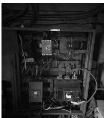
既存フィーダーピラー
