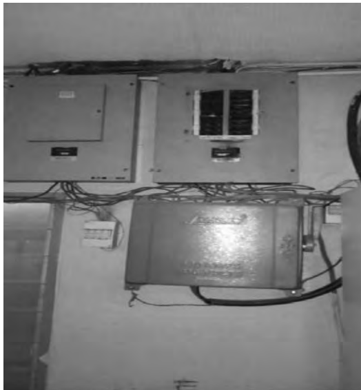
既存 100AMP 切替器
