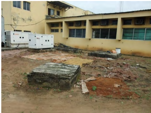
地中埋設型の浄化槽。腐敗槽、沈殿槽の2槽式で処理水は場内で地中浸透としている。写真奥は非常用ディーゼル発電機。
