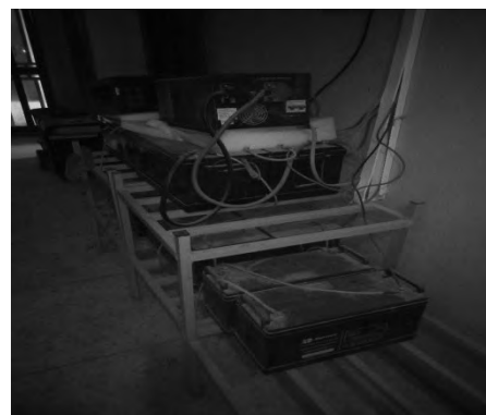
既存インバーターバッテリー
