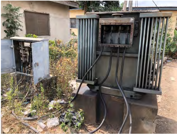
屋外型の既存変圧器300KVA。引込み電圧11kVから415Vへ降圧している。
