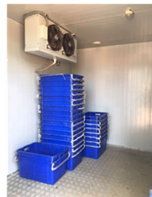
パッキングセンター内冷蔵施設
