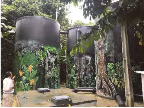
プロジェクトで整備した マナティー水槽浄化槽
