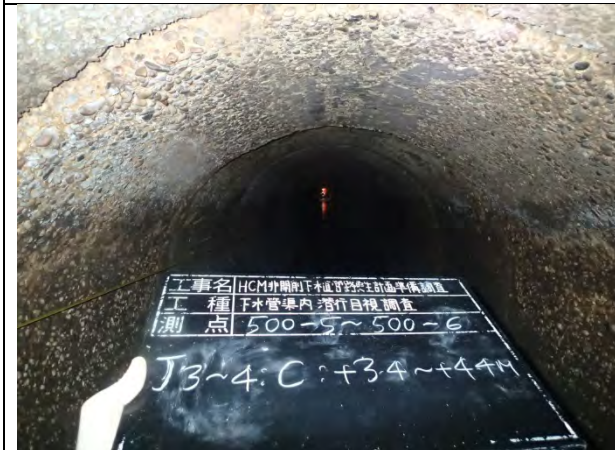
写真 2-5 : No. 8 Cach Mang Thang 8 通りの破損状況 (潜行目視調査)
