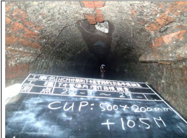
写真 2-1 : No. 1 Hai ba Trung 通りの破損状況 (潜行目視調査)
