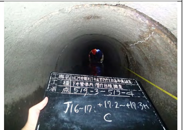
写真 2-6 : No. 9 Cach Mang Thang 8 通りの破損状況 (潜行目視調査)
