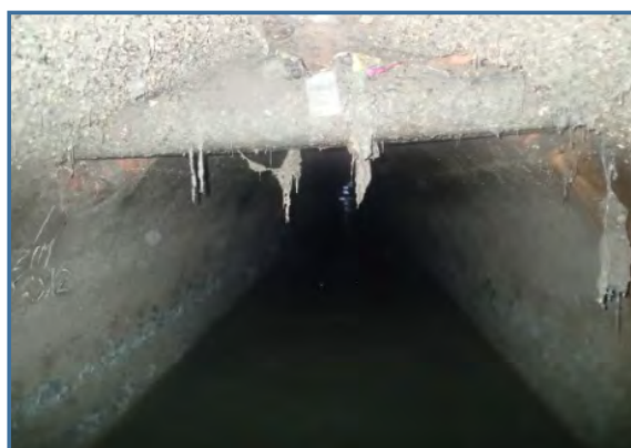
⑧No.4 Calmette における埋設管の状況
