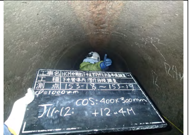
写真 2-4 : No. 7 Cong Quynh 通りの腐食状況 (潜行目視調査)
