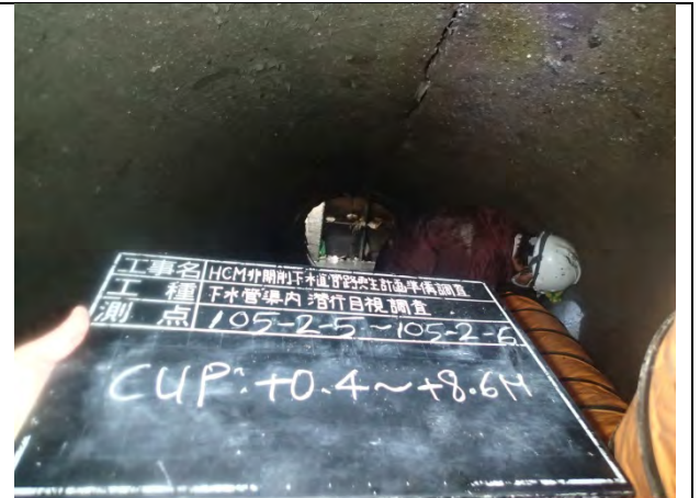
写真 2-2 : No. 3 Yersin 通りの破損状況 (潜行目視調査)
