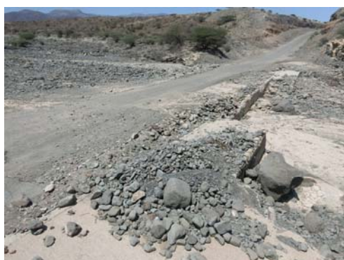
写真一 傷んだ道路の状況 (乾季のワジ部)
