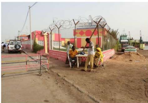
現行フェリーチケット売り場 道路沿いの売り場(3 rd July 2018)
