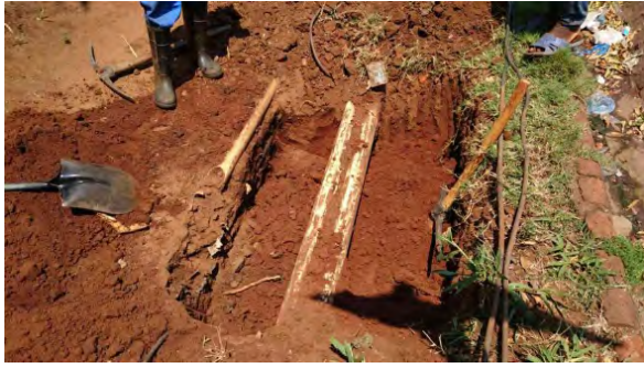
地下ユーティリティ 道路拡幅により撤去或いは移設が必要になる。
