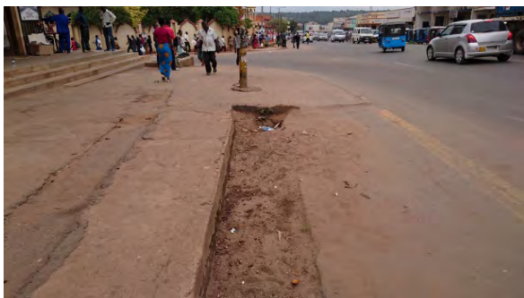
マランガランガ JCT 付近 土砂が堆積する排水路。
