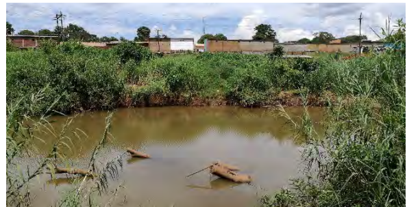
追加調査区間用地 4 (木橋の流失、人道橋として乾季に利用) 乾季にあった木橋が流失している。
