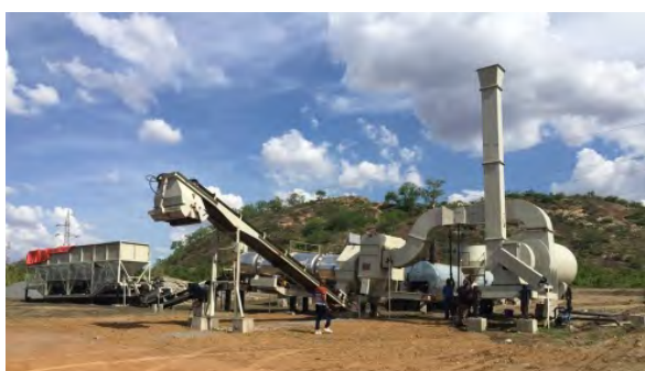
操業中のアスファルトプラント プラントを所有する現地建設業者があるが、仕 様によっては安定供給と品質確保のために日本 からの輸入も検討する。
