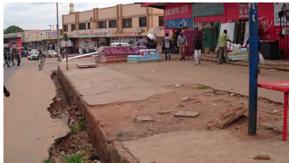
マランガランガ JCT 付近 段差があり連続性に欠ける歩道（副道）。
