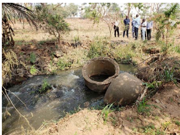
No3：損壊したマンホール
