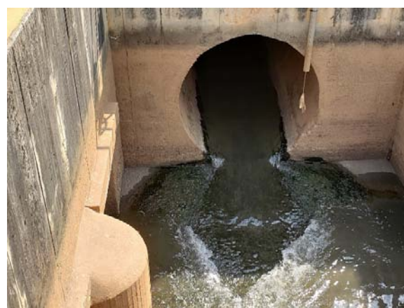
No.2 : 汚水原水の流入
