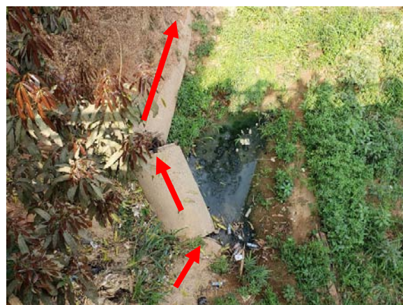
No4：河川敷内で土壌浸食によって押し流された既存下水管渠
