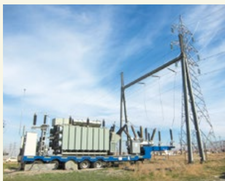
移動式変電所
