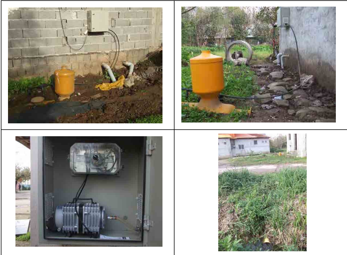
تصویر ۳-۴-۱۲ نمونه تصویر پکیج تصفیه نصب شده در روستای مبارک آباد
