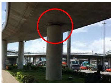
Source : Mission d'étude de la JICA Figure 2.37 Pile en forme de colonne (type une seule colonne) (fly-over de l'échangeur de Marcory)
