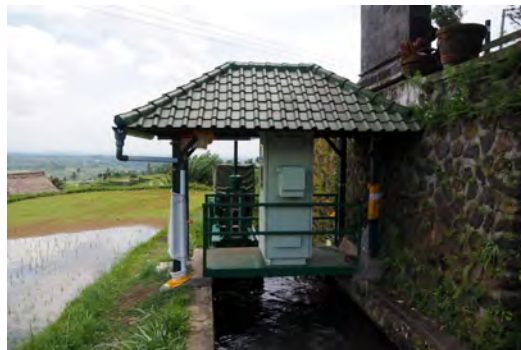
【蓄電池盤を保護する上屋】
