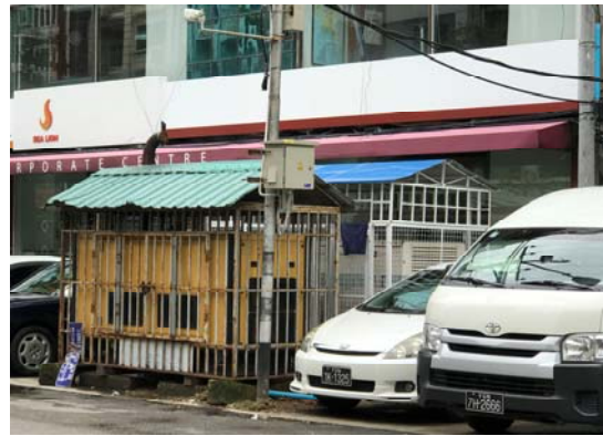
【写真 10：電力供給不安で設置される発電機】
