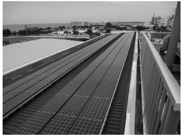
無償資金協力(モルディブ・マレ島におけるクリーンエネルギー促進計画、2010年)により設置された太陽電池モジュール
