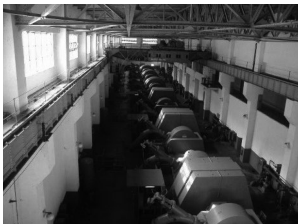
パルーチャン第二水力発電所内の発電機
