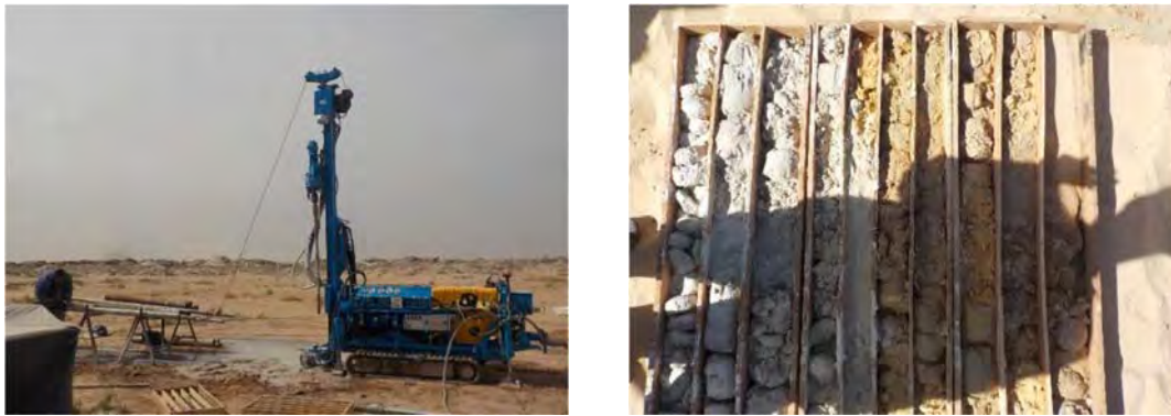
Source: Réalisation de 20 piézomètres carottés équipés d'enregistreurs automatiques et de deux forages (2015)
