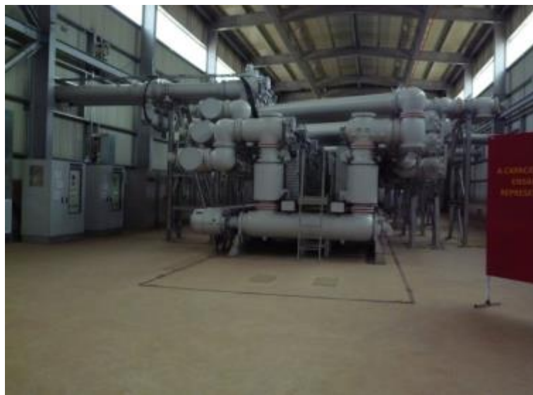
図 7-17 屋内型ガス絶縁開閉装置
