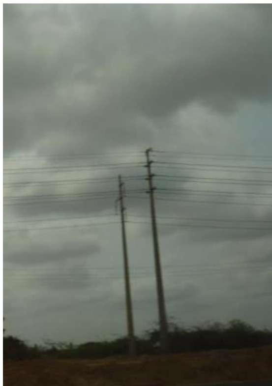
図 7-5 60kV コンクリート柱
