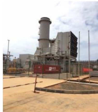
No. 4 ガスタービン
