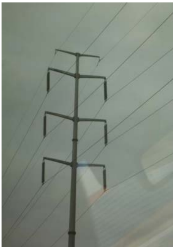
図 7-10 220kV 鋼管柱 (懸垂)
