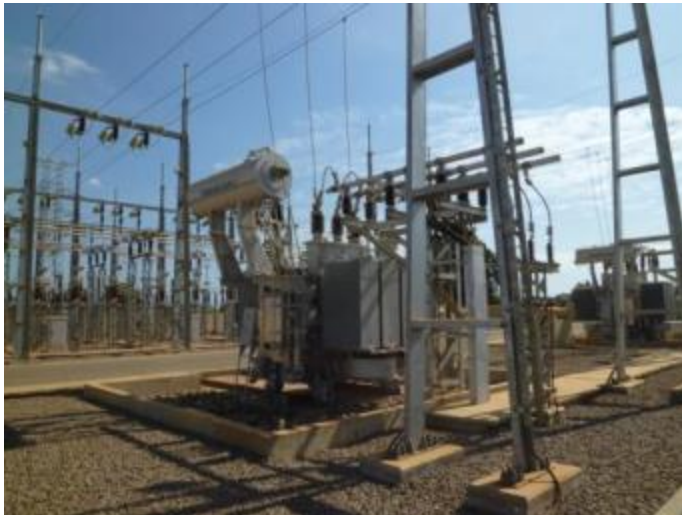
図 7-14 中国製 66kV/15kV 変圧器
