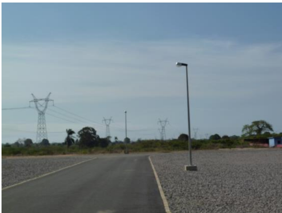
図 7-13 400kV1 回線送電線（遠景）
