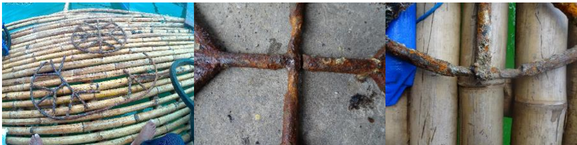
鉄製リングの損傷状況
