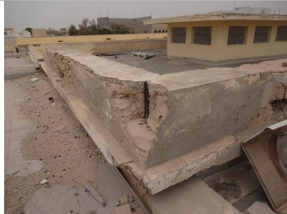
老朽化した既存ヌアディブ検査所施設(1952年建造)。貝殻を使用した外皮が剥離し、鉄骨がむき出しになっている。
