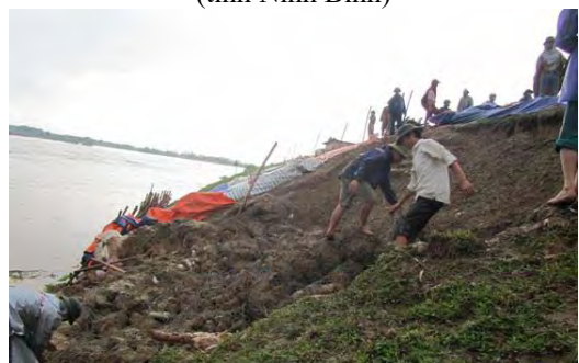
Sạt lở bờ và giải pháp khẩn cấp (đóng cọc cừ) Bờ tả sông Chu (tỉnh Thanh Hóa)
