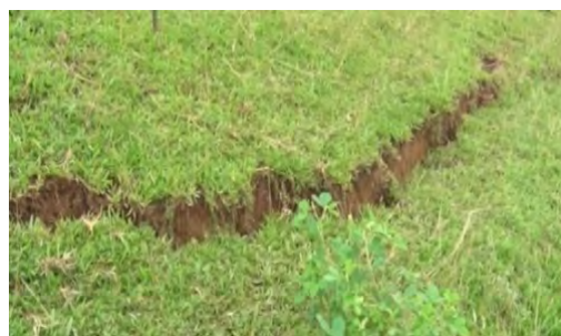
Nứt dọc mái đê tả sông Chu (tỉnh Thanh Hóa)
