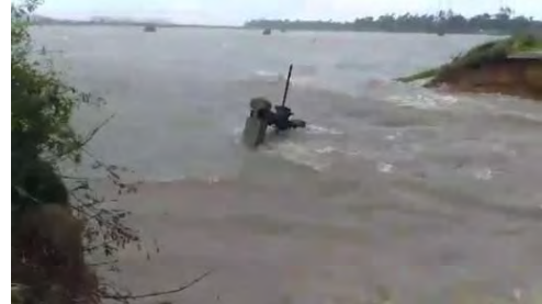
Vỡ đê và cống lấy nước (đê tả Nghèn tỉnh Hà Tĩnh)
