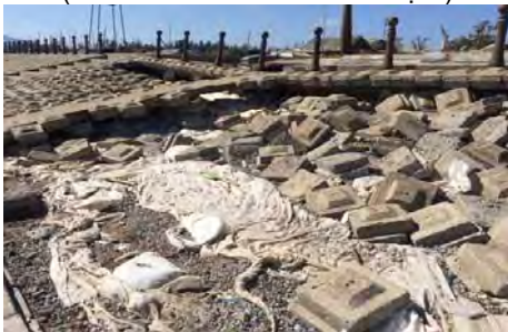
Sạt lở kè đê biển (tỉnh Hà Tĩnh)
