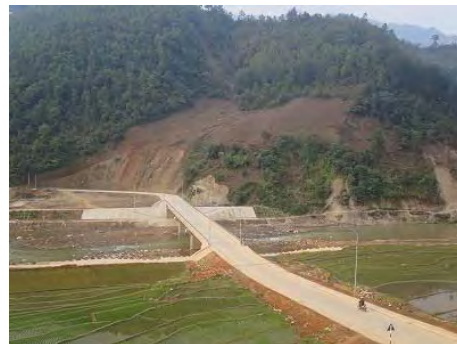
Ảnh 2.6 Tình trạng sườn dốc không ổn định dọc cầu và đường (Tỉnh Yên Bái)
