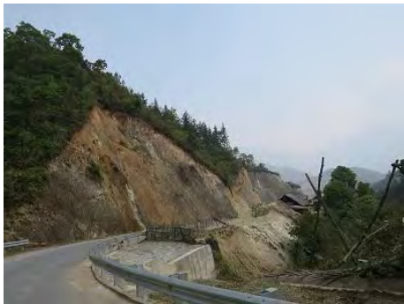
Ảnh 2.3 Sạt lở mặt đường tỉnh lộ (Tỉnh Sơn La)
