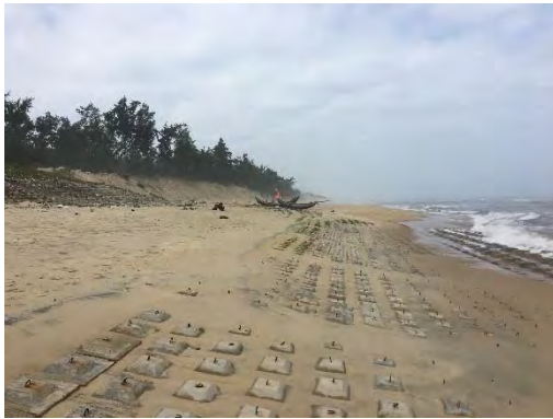
Khối bê tông chống sạt lở (khối bê tông giảm sóng ở trước bờ biển.)
