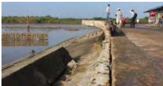
Ảnh 2.13 Ảnh sạt lở bờ biển tỉnh Bạc Liêu
