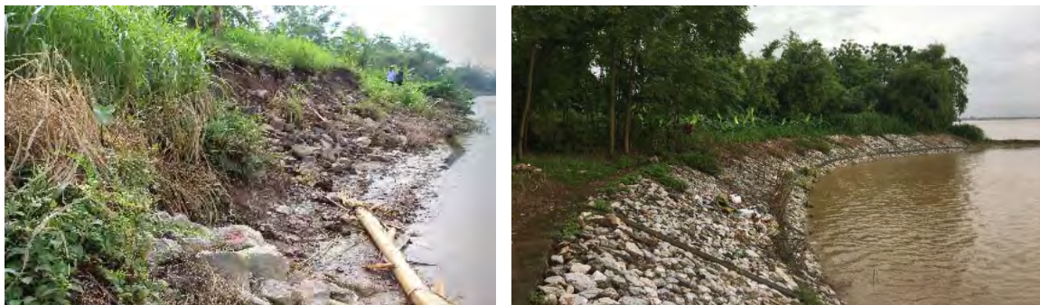
Ảnh 4.4 Sạt lở bờ sông ở thành phố Hưng Yên
