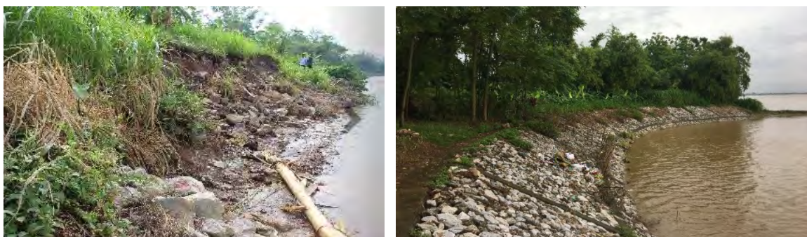
写真 4.4 Hung Yen 市で発生した河岸侵食状況 (左：対策前、右：対策後)
