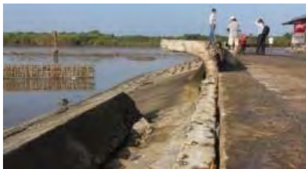
写真 2.13 Bac Lieu 省の海岸侵食被災状況
