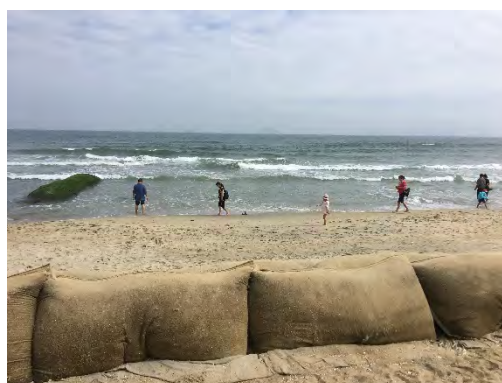
砂嚢の設置 （汀線と平行に設置するものと突堤として流砂を貯めるものを配置している）
