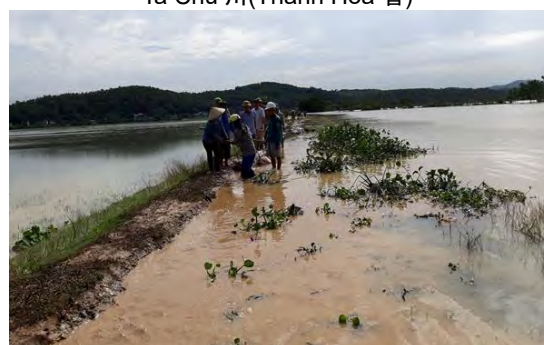
堤内地への越流と応急措置（土のう積み） Huu Hoat 川(Thanh Hoa 省)
