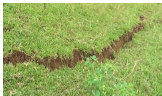
堤防法面のクラック Ta Chu 川(Thanh Hoa 省)
