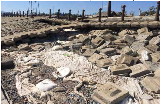
海岸堤防の護岸ブロックの崩壊 (Ha Tinh 省)
