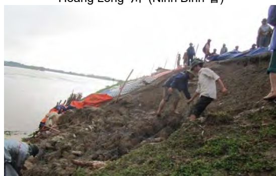
堤防法面の侵食と応急措置（シート張り） Ta Chu 川(Thanh Hoa 省)
