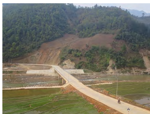
写真 2.6 新設道路及び橋梁に接する不安定斜 面の状況 (Yen Bai 省) 道路に接する斜面末端部は崩壊が発生している。 (2018 年 3 月 JICA 調査団撮影)
