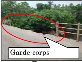
Photo ⑤: Garde-corps perdu par la collision etc. de véhicule
