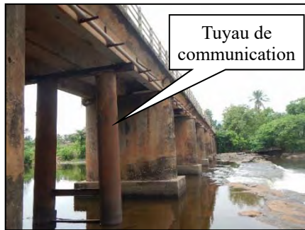
Tuyau de communication (fibre optique)
