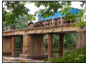
Photo ⑩: Véhicule lourd passant sur le pont Soumba renforcé
