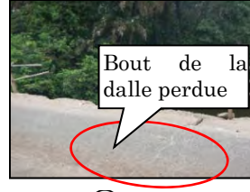
Photo ⑦: Bout de la dalle perdue par la collision etc. de véhicule
