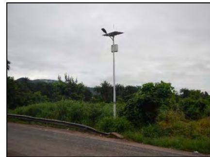
Poteau d'éclairage solaire (pendant la journée)
