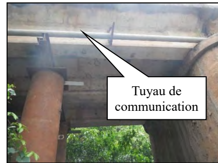
Tuyau de communication (fibre optique)
