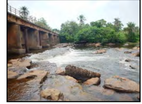
Photo ⑫: Fleuve Soumba où l'affleurement des roches est partout présent (la capacité portante pour la fondation est suffisante)
