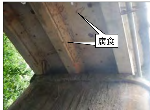
⑫ 腐食・劣化の著しい主桁及び床版
