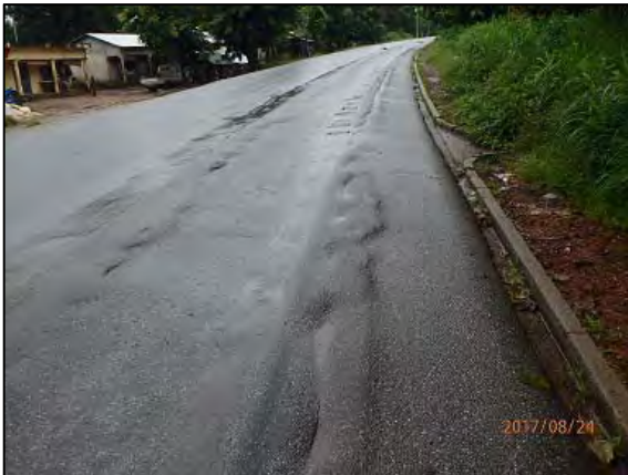
写真 3-2-6 スンバ橋取付け道路のわだち掘れ
