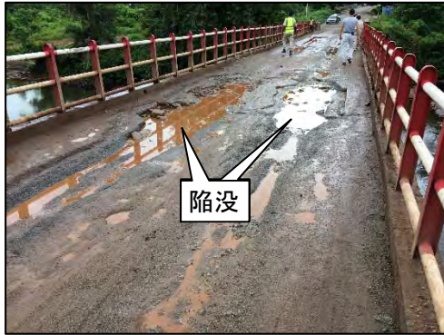
⑨ 損傷の著しい橋面の舗装
