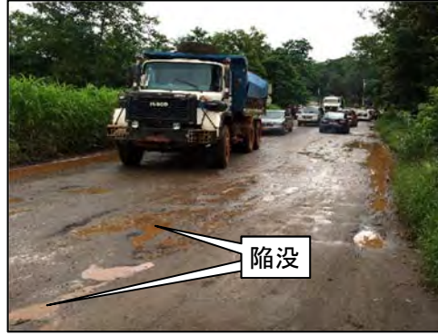
⑩ 損傷の著しい取付道路面の舗装
