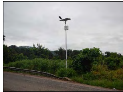
ソーラー式照明灯（昼間）
