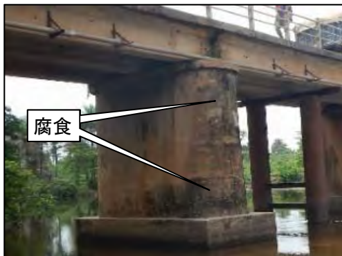
⑪ 腐食・劣化の著しい橋脚
