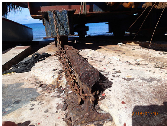
レール前端部の腐食
