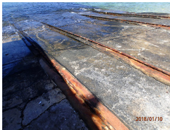
レールの腐食
