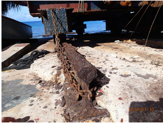
レール前端部の腐食
