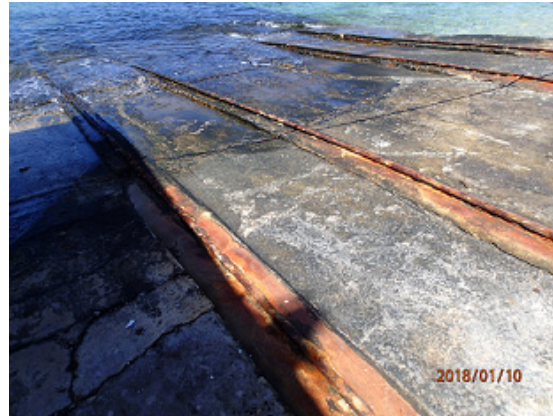
レールの腐食
