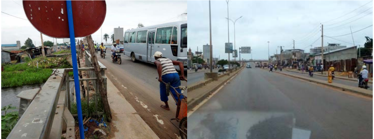
損傷の激しい橋梁（国際国道2号：ジョノー橋）
