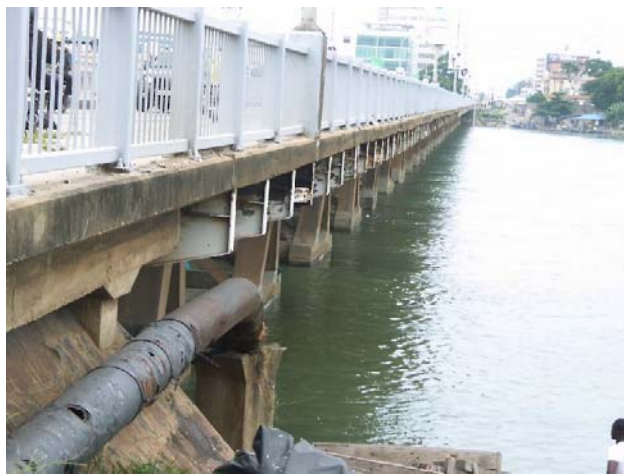
劣化の進んだ最も古いラグーン橋梁
