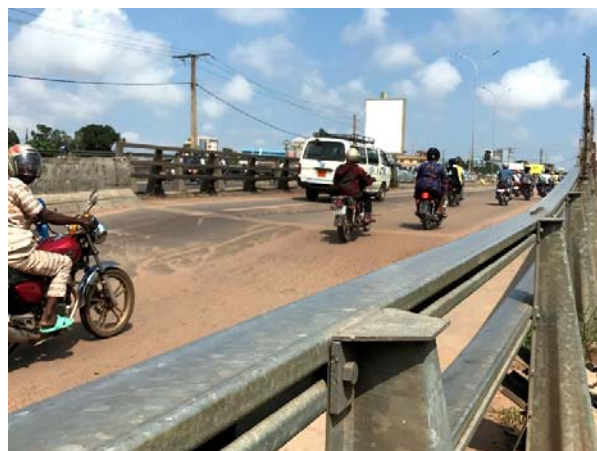
アプローチ道路区間の沈下による橋梁部と道路区間との段差
