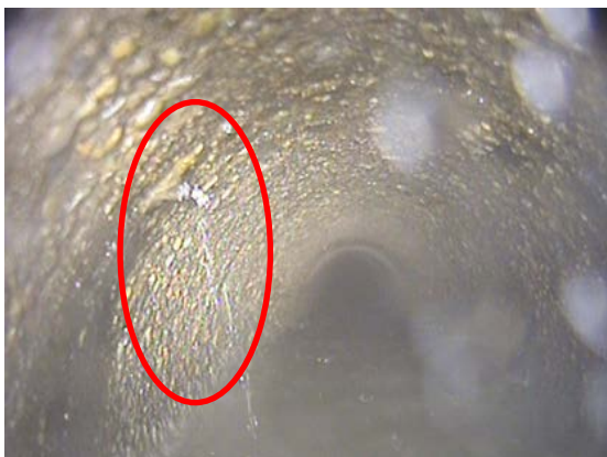
Imagen de la infiltración de agua (Don Bosco)
