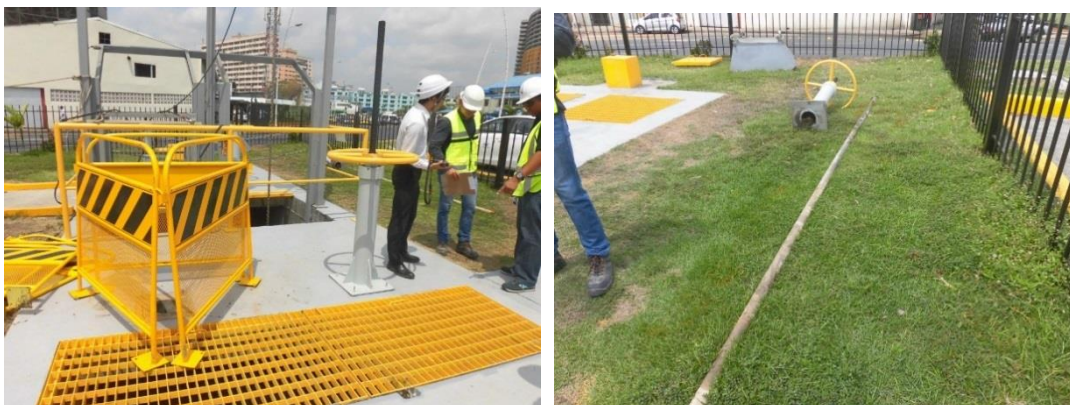
Eje erosionado y quebrado de compuerta de entrada a la estación de bombeo No.1 (instalado en mayo de 2009)
