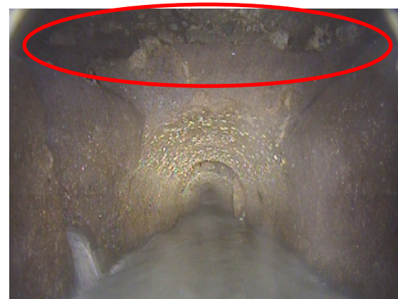
Rotura de tubería en la parte superior del tubo (Chanis)
