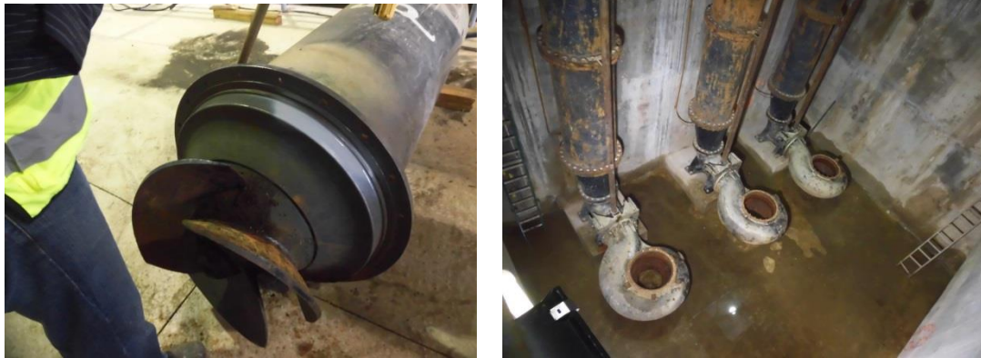
Estación de bombeo Juan Díaz (17/03, antes de la operación de prueba, bombas oxidadas no funcionan.)
