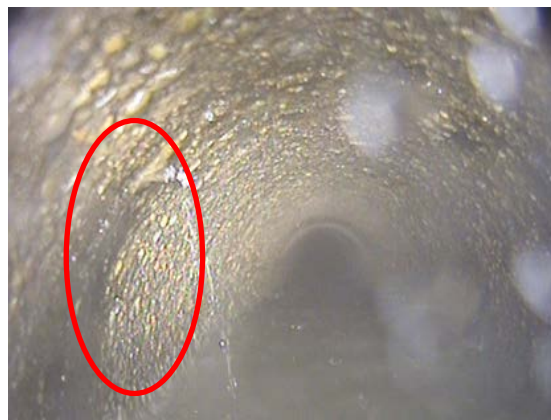
Imagen de la infiltración de agua
