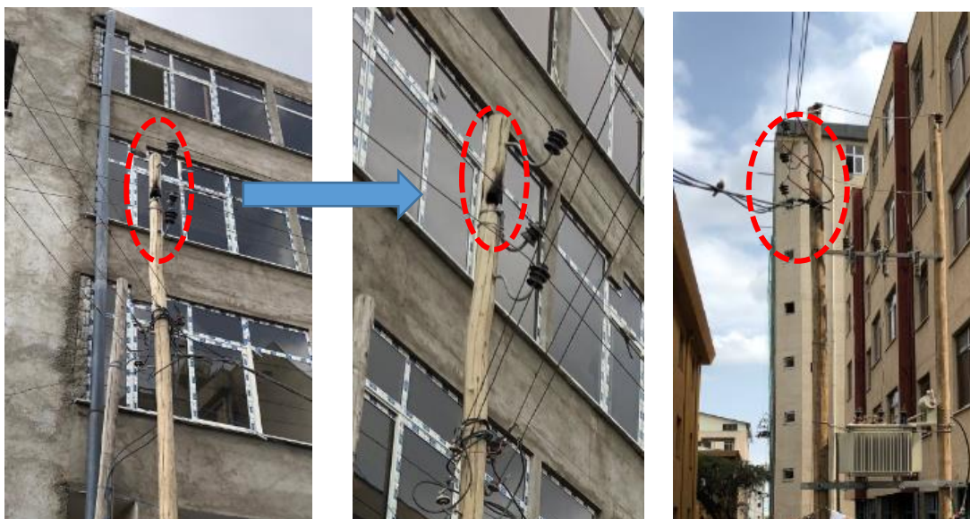
図 8.5-8 現場調査時に発見した木柱の焼損現場
