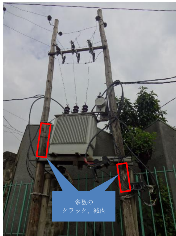
図 7.4-1 木柱に施設された変圧器例
