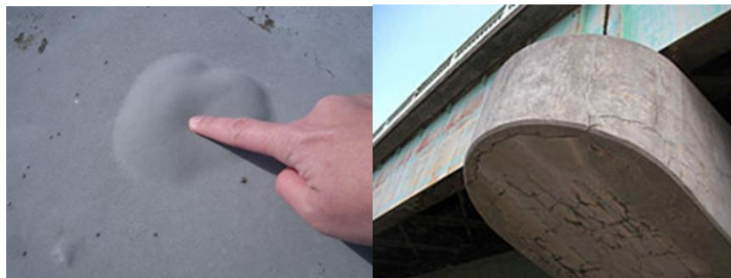
図 59 従来型の表面保護工のふくれ、はがれの様子
