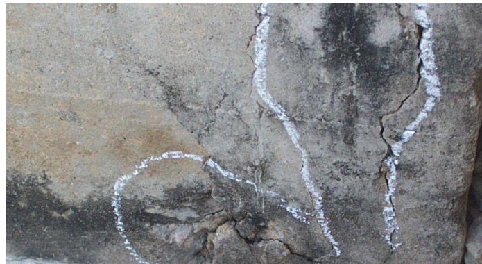
図 29 ひび割れの様子 (DOH マニュアル掲載) 66
