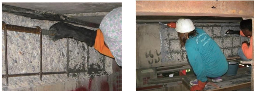
図 4 2 補修状況(左：損傷部分のコンクリートを除去、右：モルタル補修) 100
