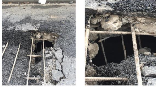
図 6 パッタナカン高架道路陥没事故の様子 17
