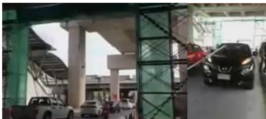
図 8 1 高所作業中に発生した事故の様子
