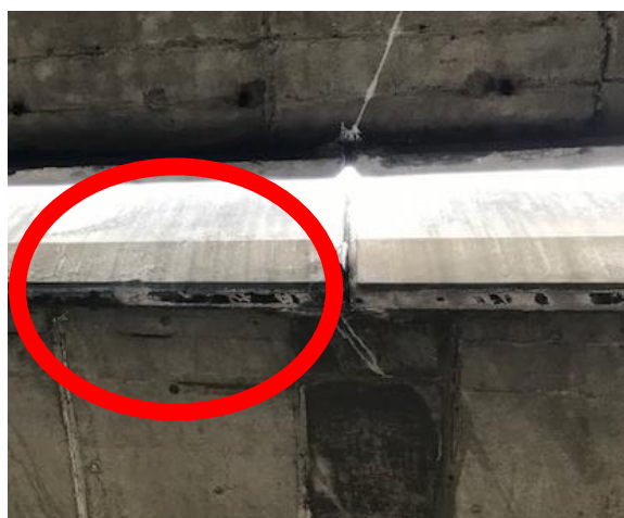
図 7 2 “はく落”が発生したと推測される痕跡
