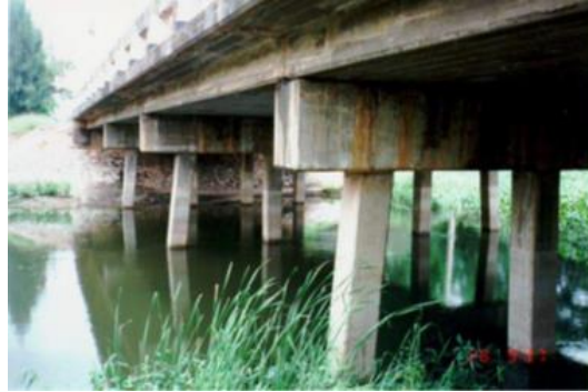
図 9 タイ国の橋梁における塩害の様子 19
