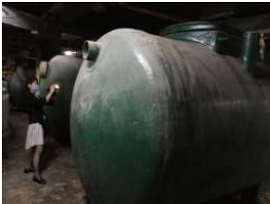
既設汚水処理装置
