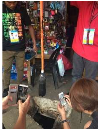
STT#4の一つ目のマンホール
