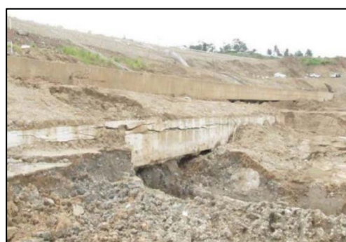
図 1-8 盛土がすべった後の状況
