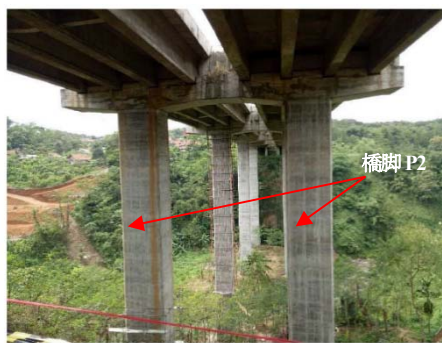
図 3-3 Cisomang 橋の橋脚状況写真
